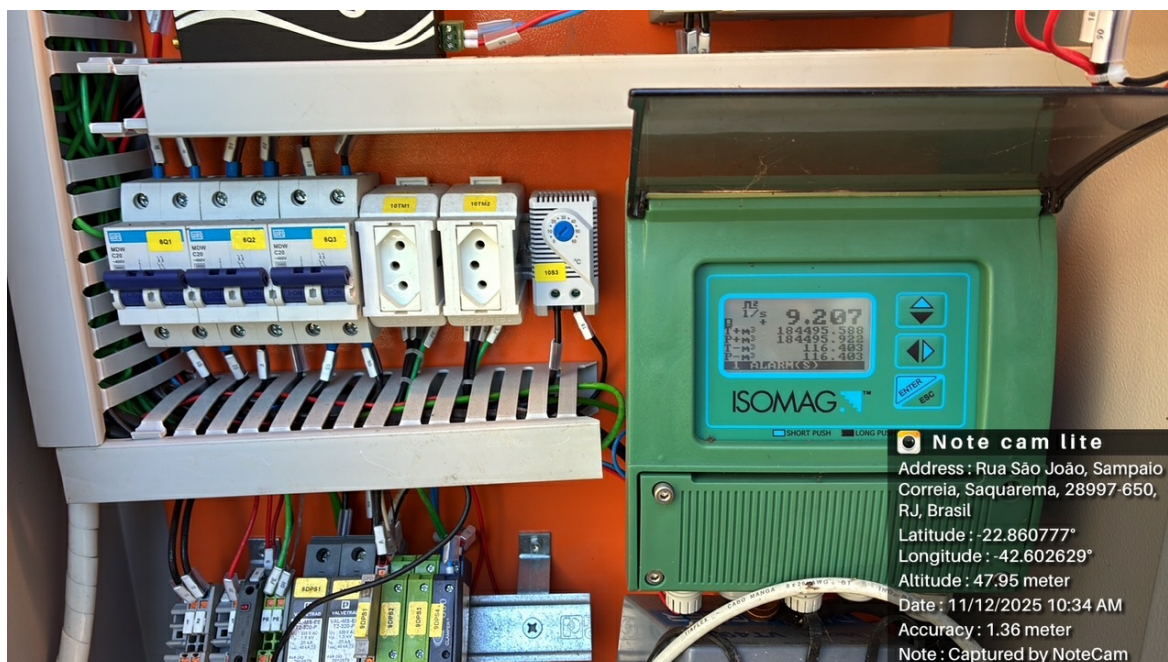
Foto 09 – Painel de automação demonstrando vazão da operação durante a fiscalização.
