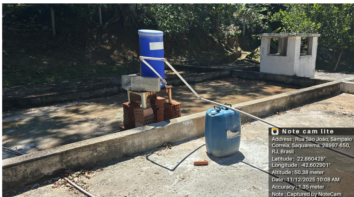
Foto 08 – Dosadora de cloro sobre a laje do reservatório.
