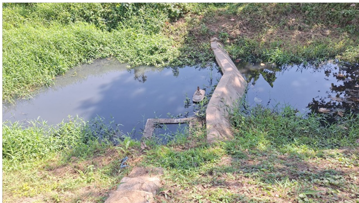
Fotos 5 – Vista externa da barragem da CTS da EEE Dona Moça , com córrego todo eutrofizado.
