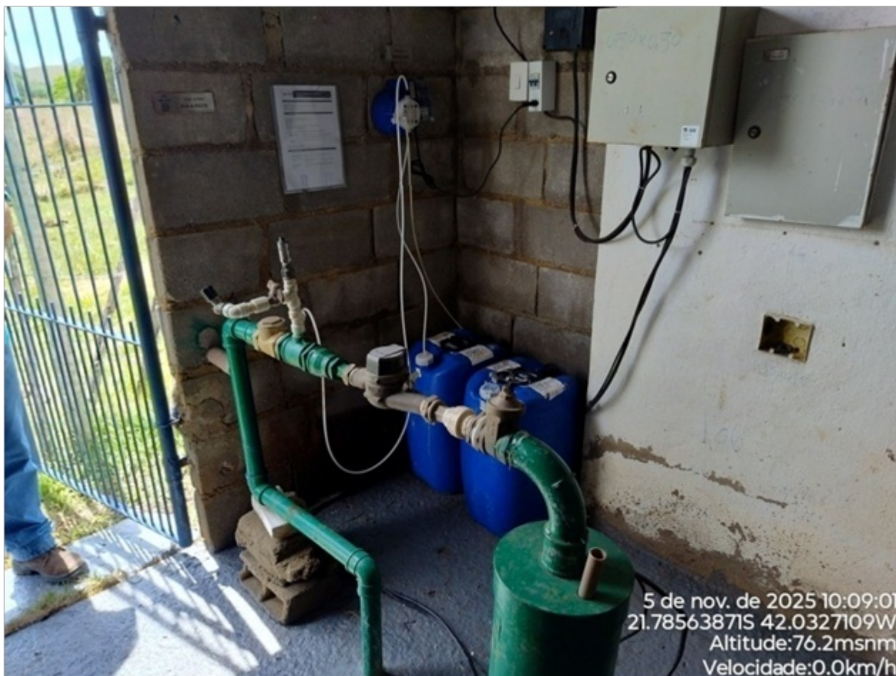
Foto 03: Barrilete do poço, painel de comando e dosador para cloração.
