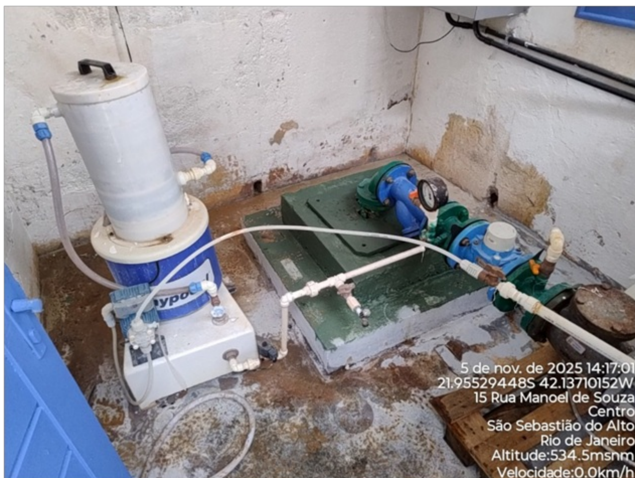
Foto 04: Equipamento de cloração em pastilhas.
