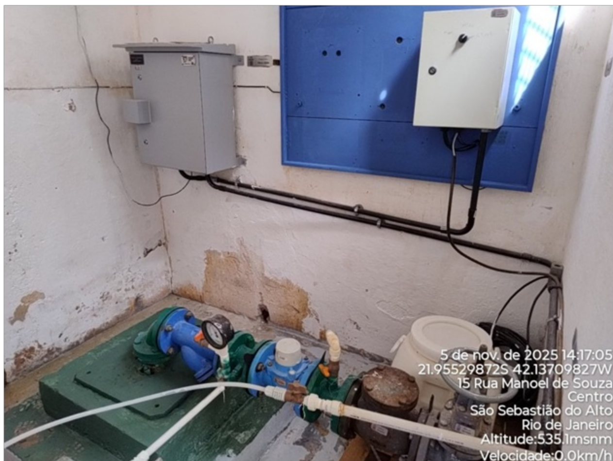
Foto 03: Barrilete do poço, painel de comando e macromedidor.
