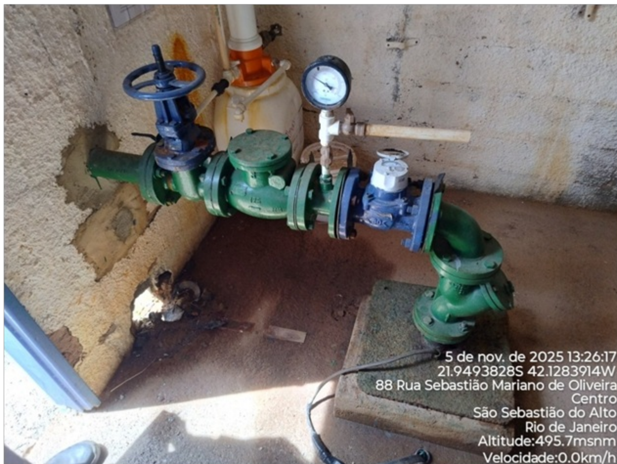
Foto 03: Barrilete do poço.
