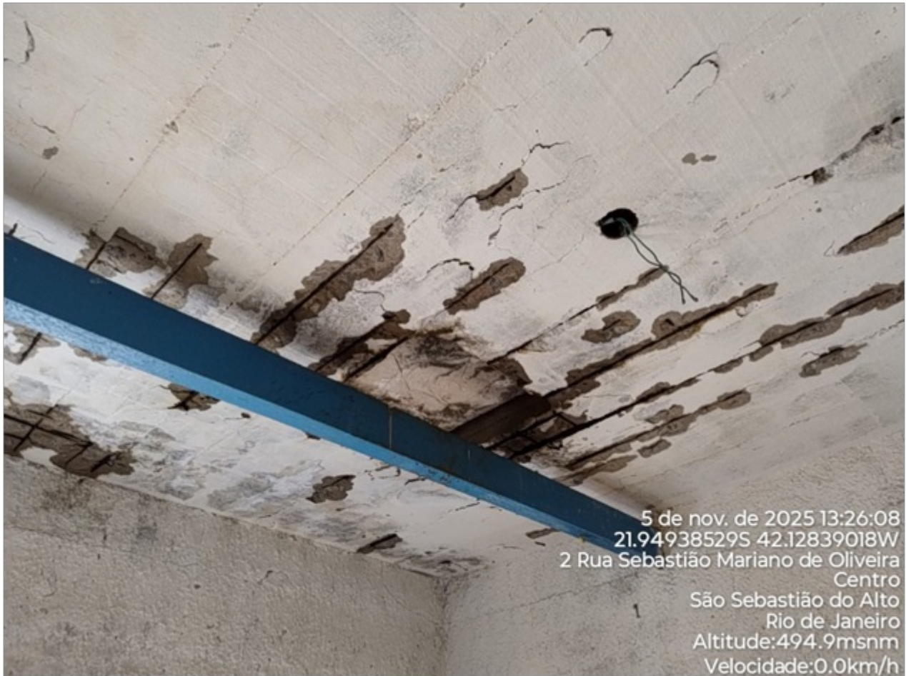
Foto 05: Ferragens da armadura da laje aparentes e apresentando corrosão.
