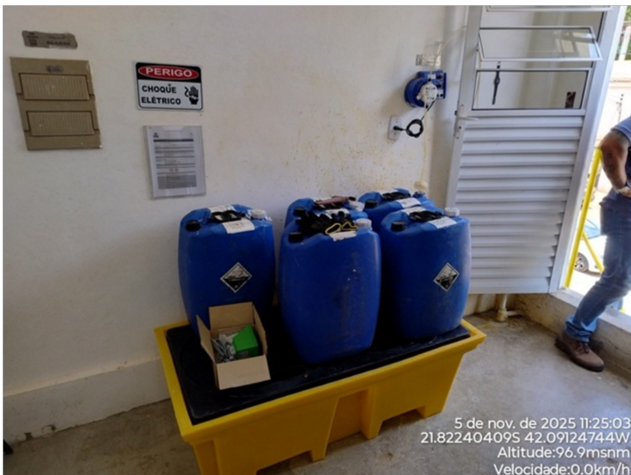
Foto 14: Dosador de Sulfato de alumínio (agente coagulante).
