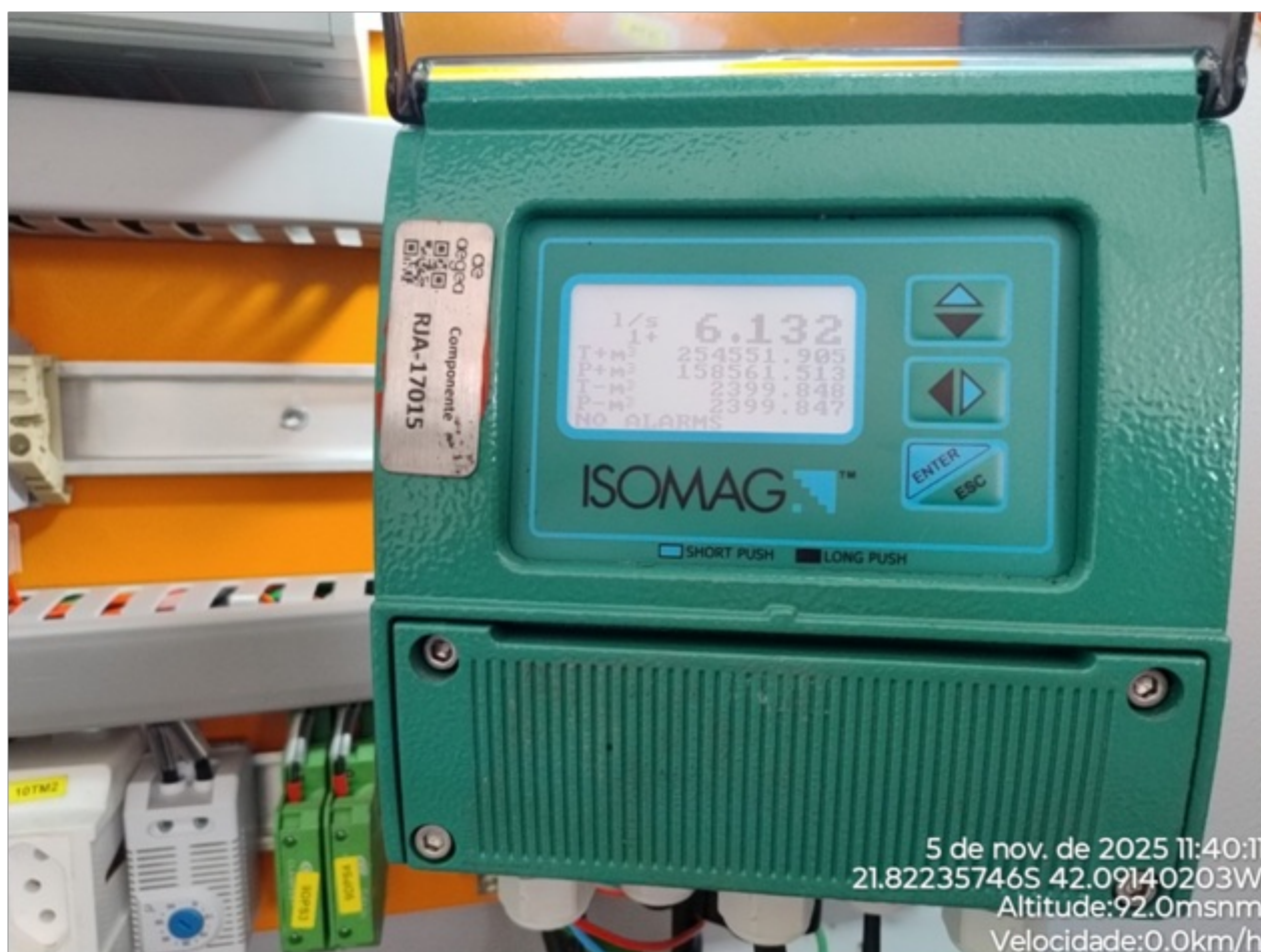
Foto 19: MACROMEDIDOR DE ÁGUA TRATADA.
