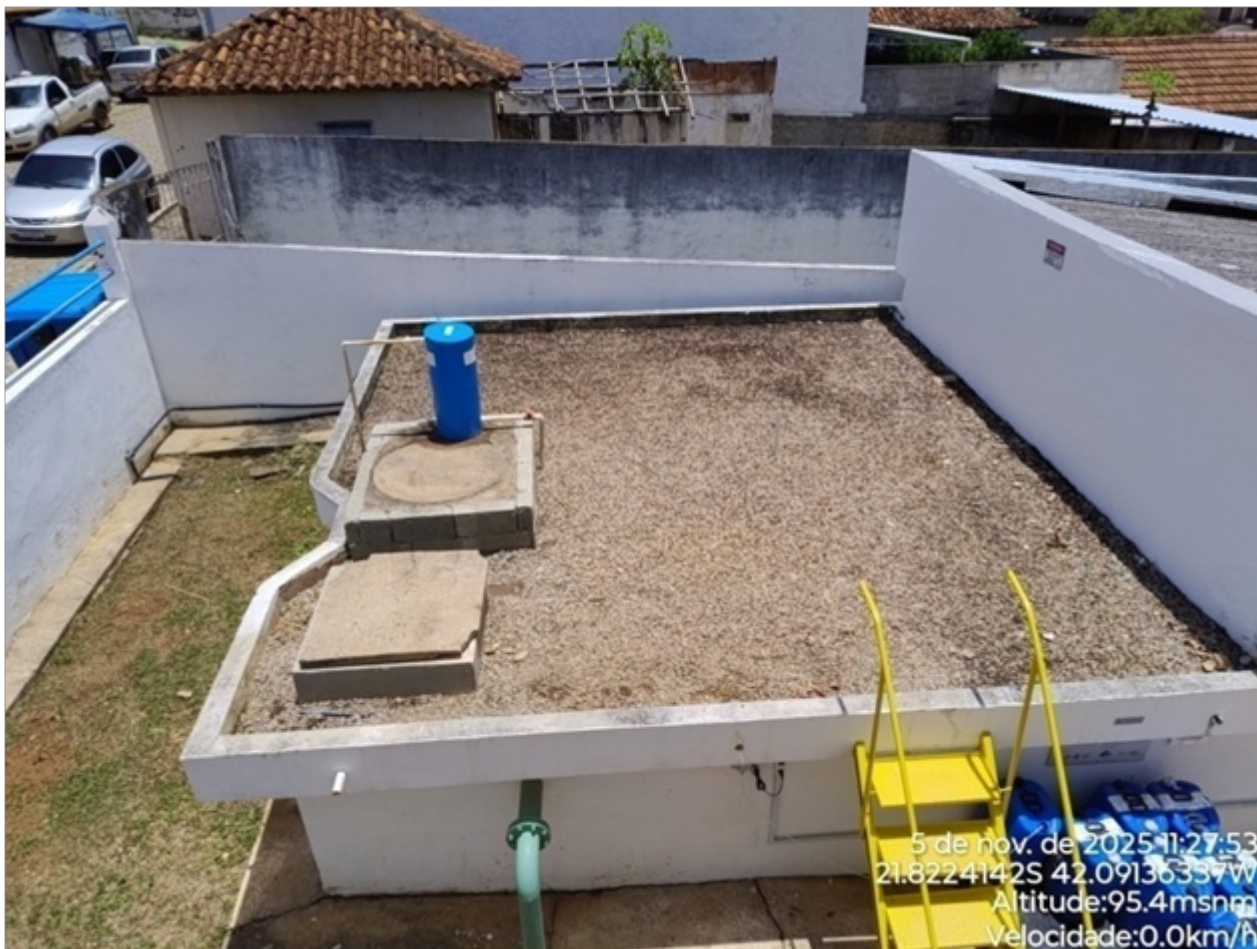
Foto 09: Câmara de contato da água tratada.
