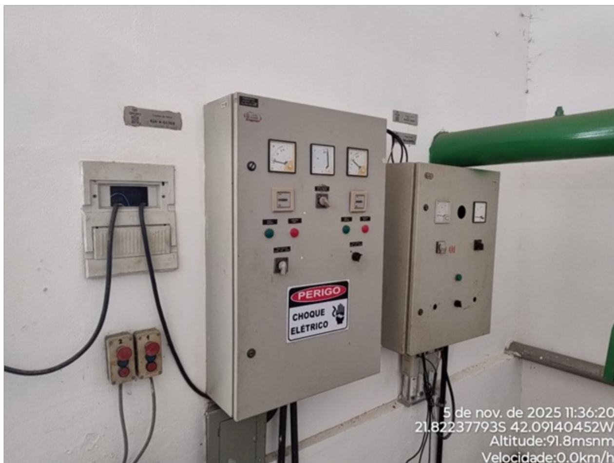
Foto 18: PAINEL DE COMANDO DA EEAT.
