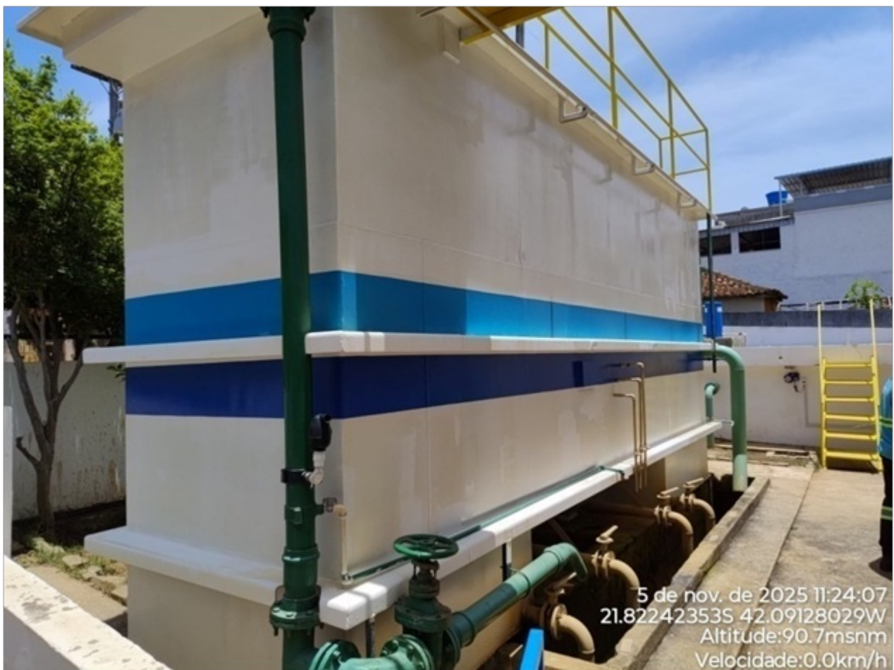
Foto 03: Módulo de tratamento.
