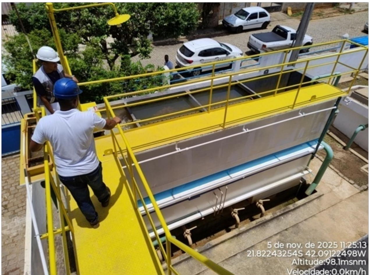
Foto 04: Módulo de tratamento.
