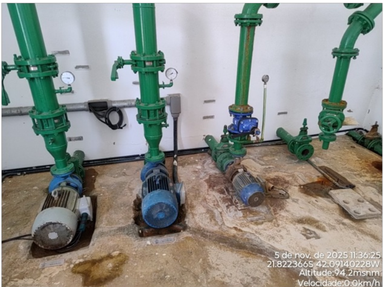
Foto 17: Bombas da EEAT e da lavagem de filtro.
