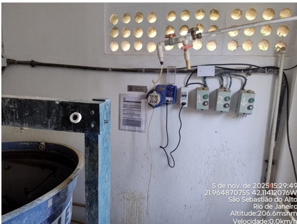
Foto 04: Dosador de Sulfato de alumínio (agente coagulante).
