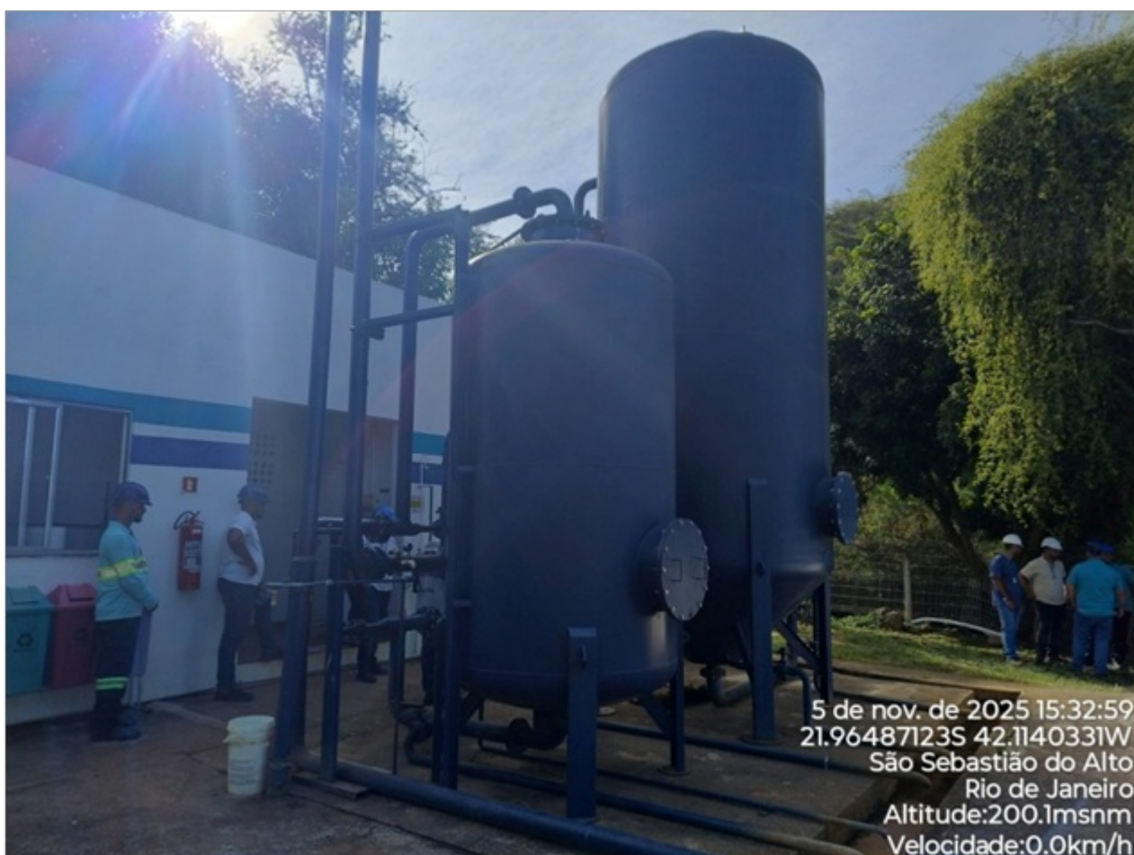
Foto 03: Decantador cônico e Filtro.
