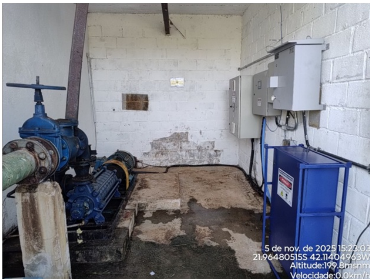
Foto 13: Bomba da EEAT e painel de comando.
