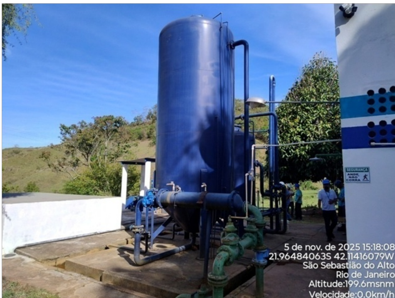
Foto 02: Decantador cônico e Filtro.
