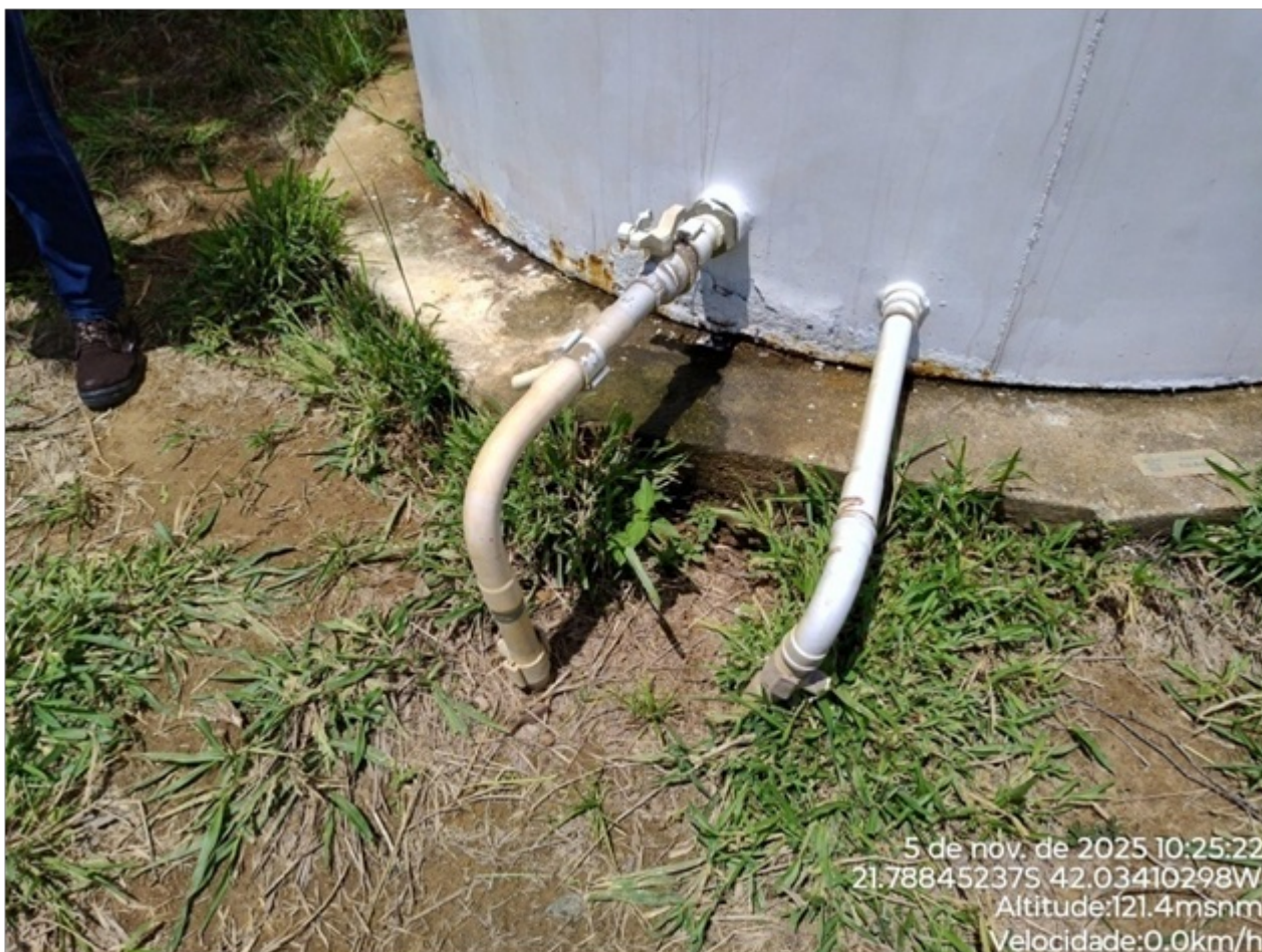
Foto 05: Tubulações de 60 mm DN.
