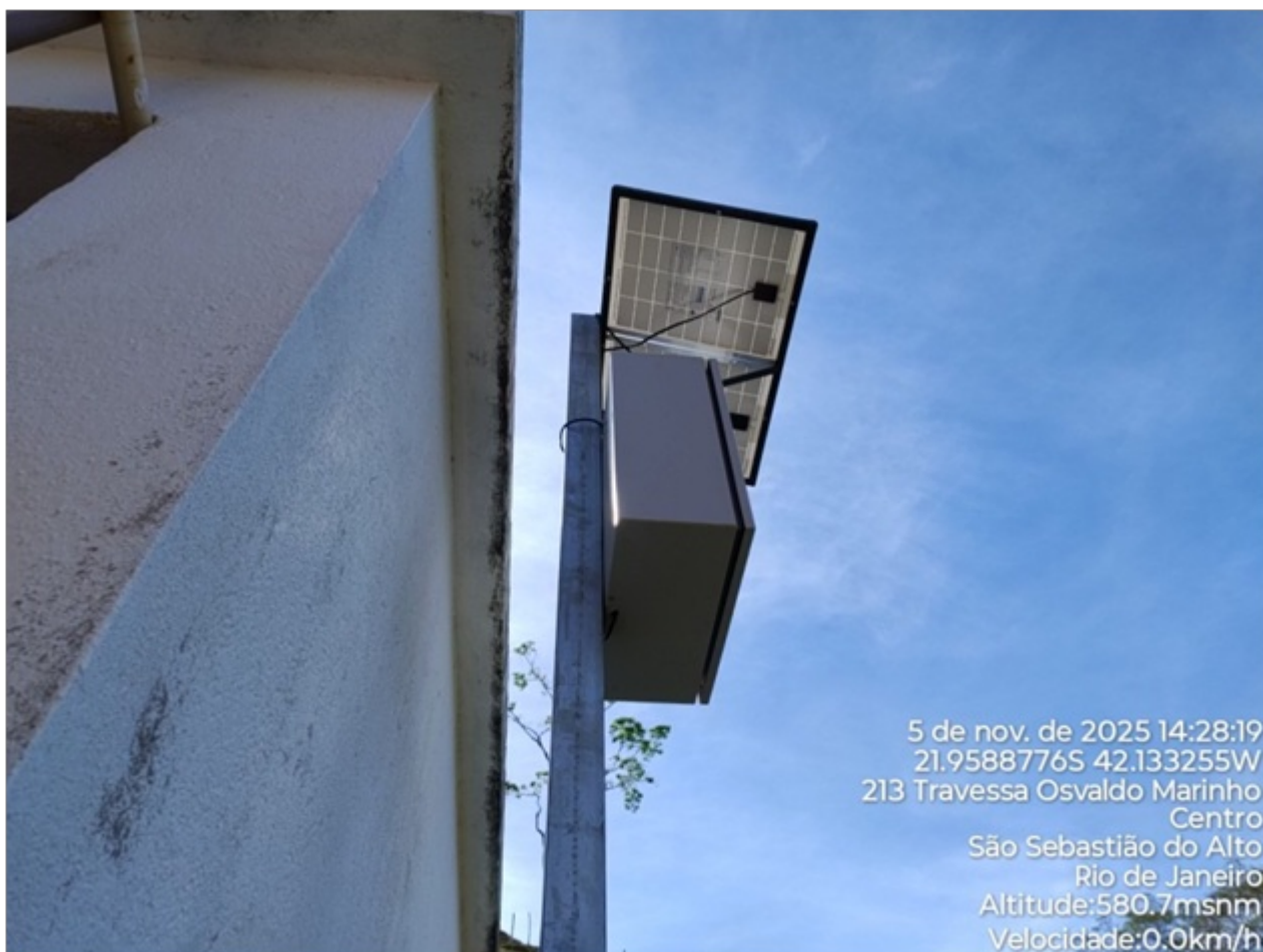
Foto 06: Equipamento de telemetria e controle.
