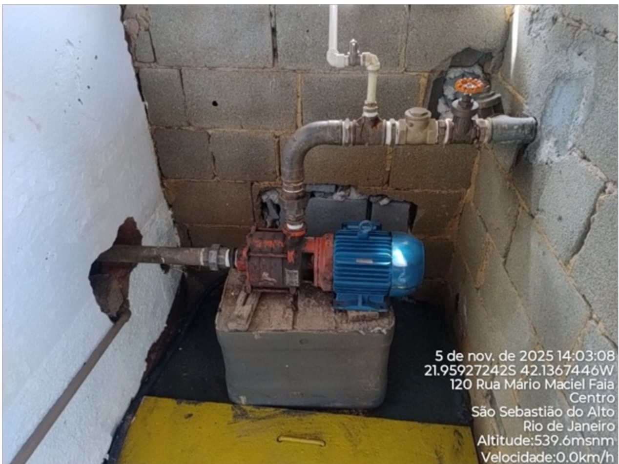
Foto 05: Bomba da EEAT.
