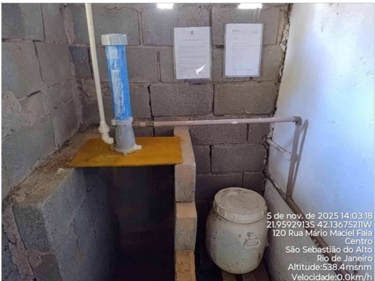
Foto 06: Equipamento de cloração.
