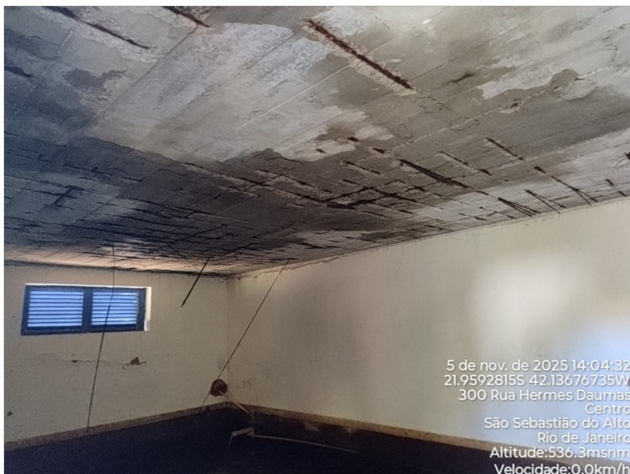
Foto 11: Ferragens da armadura da laje aparentes e apresentando corrosão.
