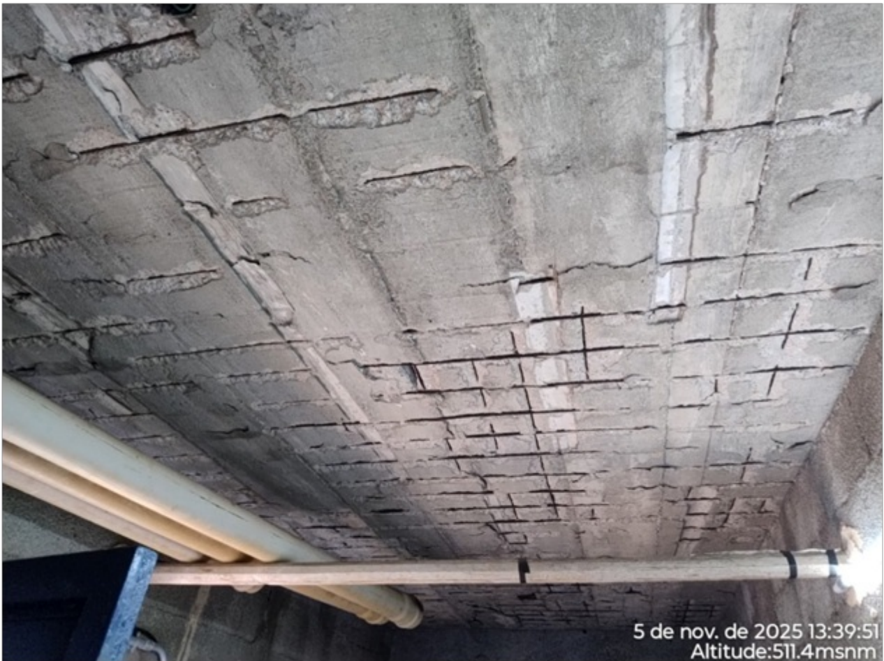
Foto 07: Ferragens da armadura da laje aparentes e apresentando corrosão.
