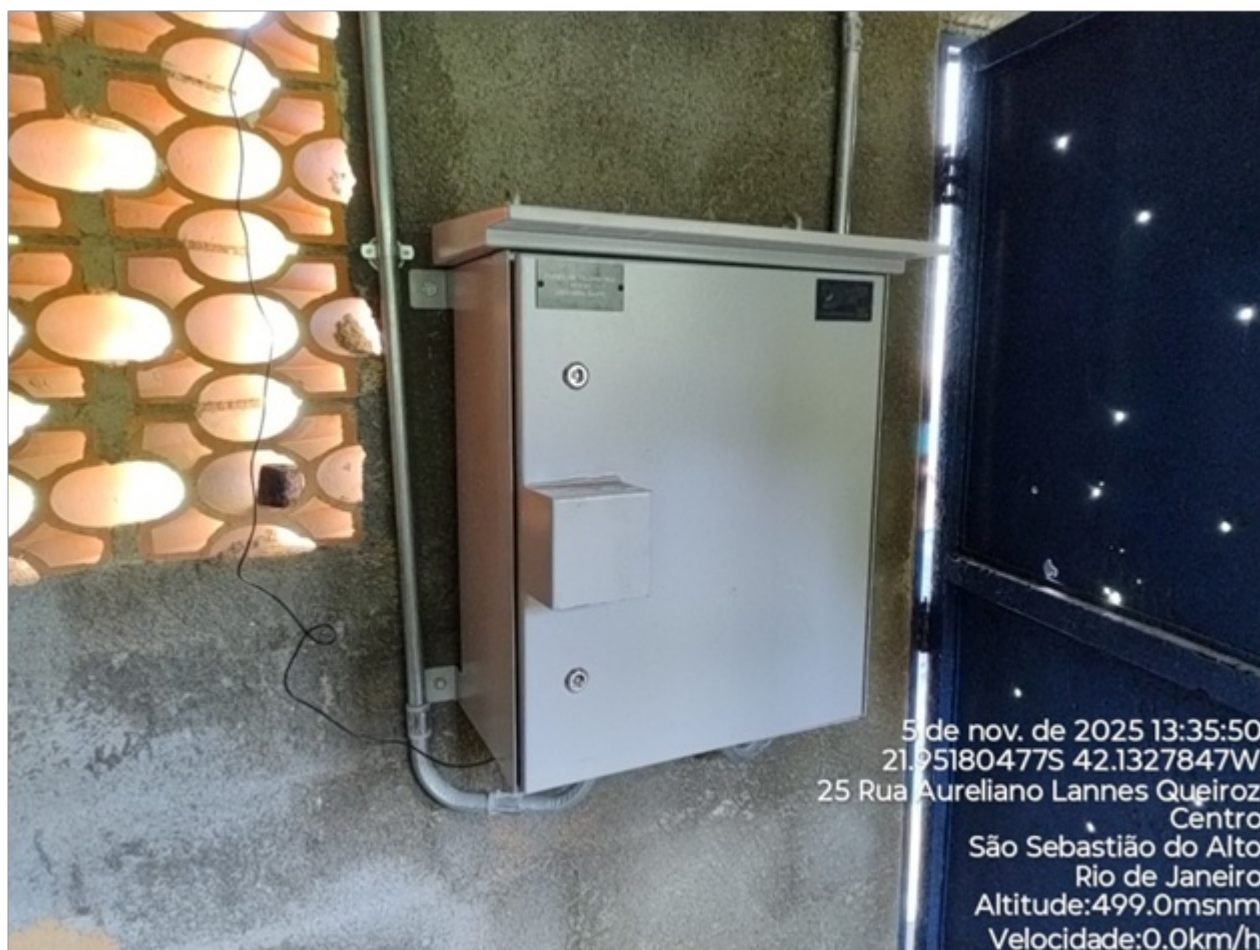
Foto 05: Macromedidor da EEAT.
