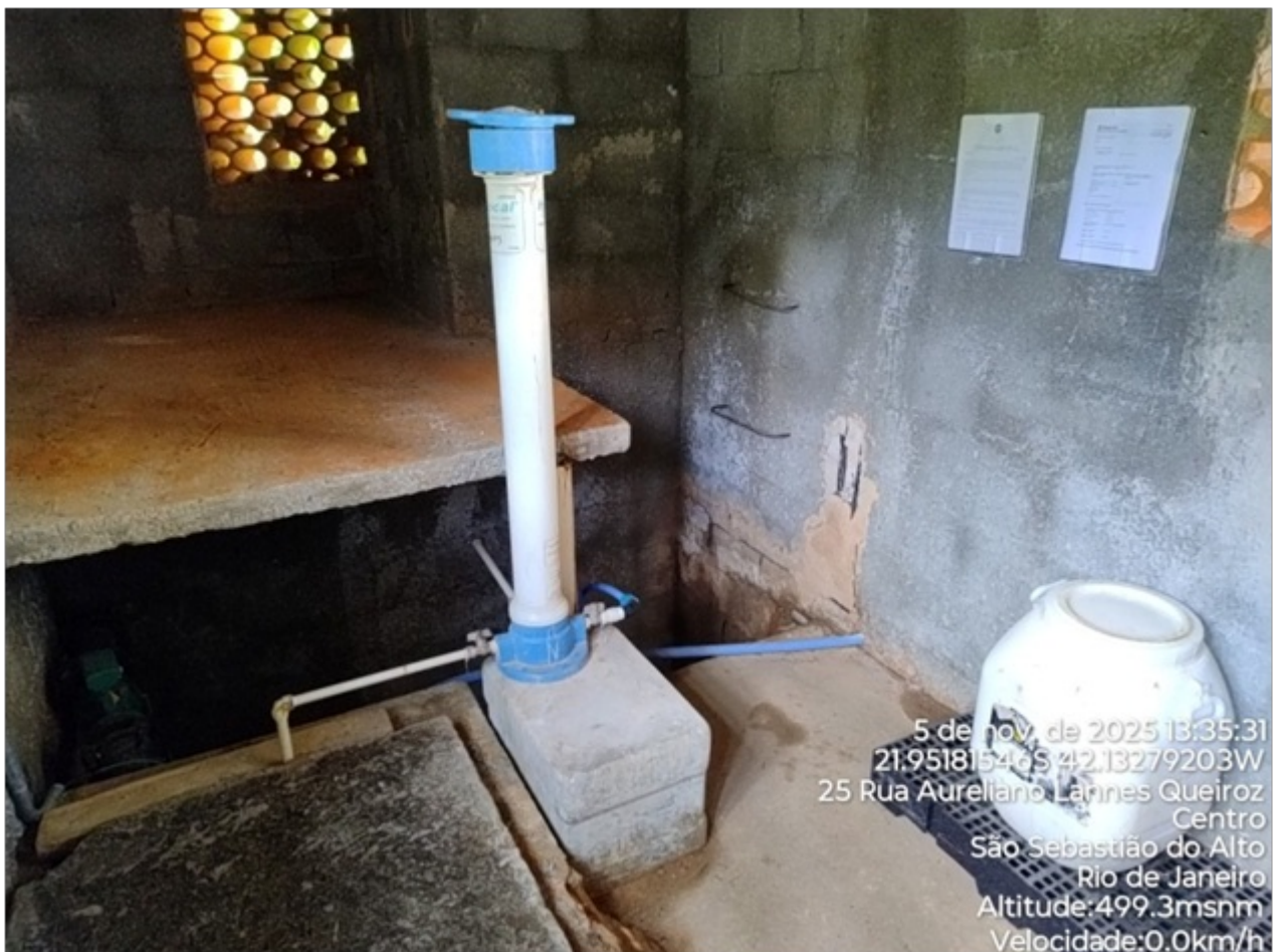
Foto 04: Equipamento de cloração.
