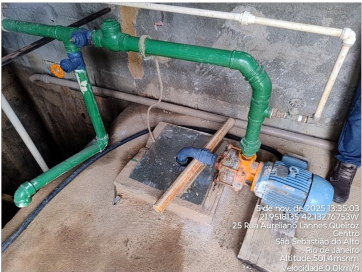
Foto 03: Bomba da EEAT..
