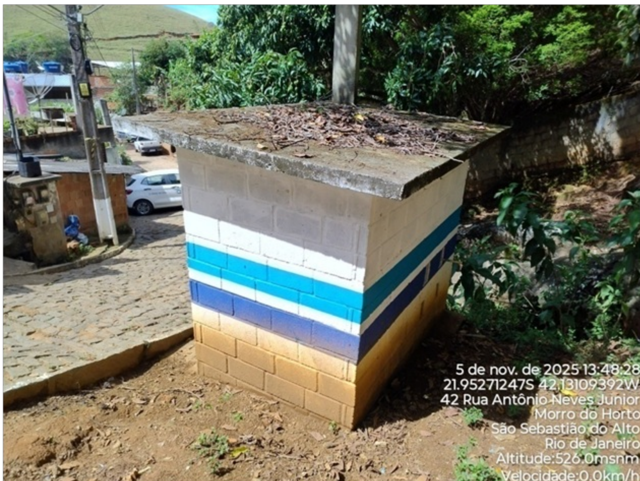
Foto 02: Abrigo da elevatória isolado e com restrição de acesso.
