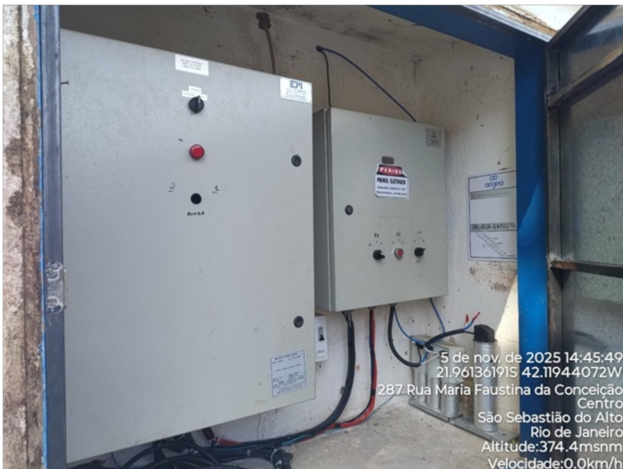
Foto 03: Pannel de comando a EEAT.
