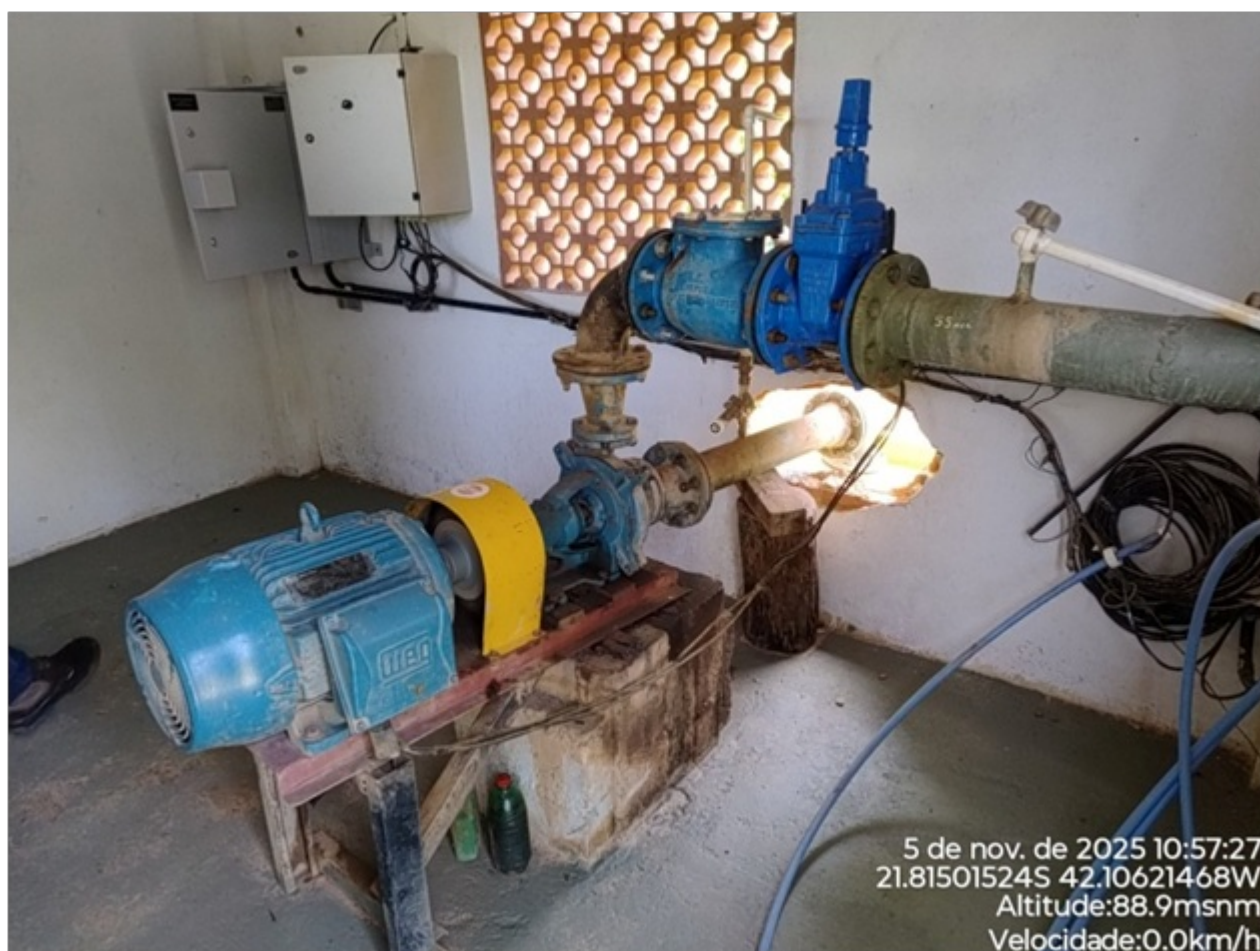
Foto 04: Bomba e painel de comando da EEAB .
