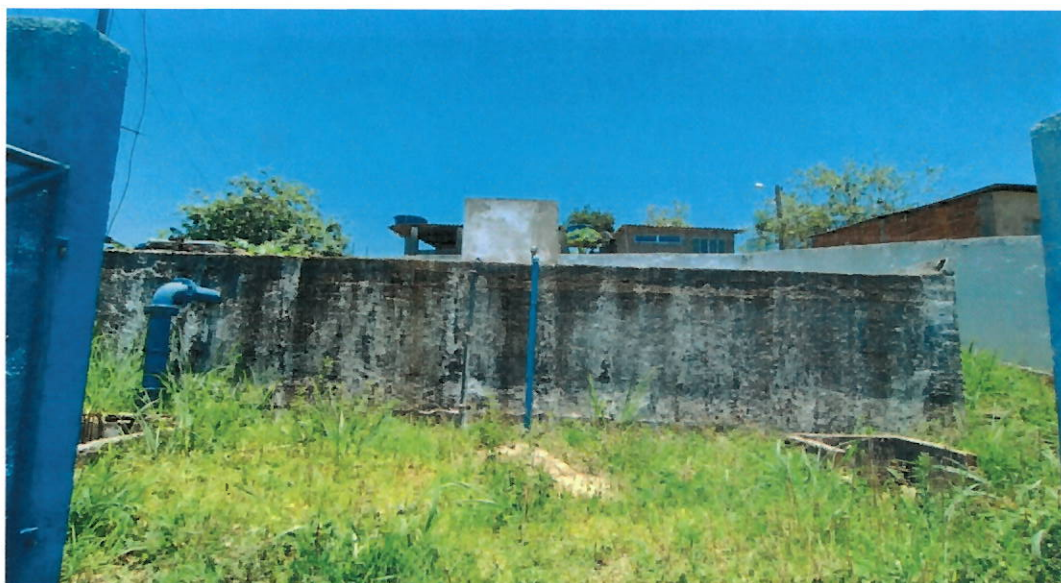
Foto 2: Vista do reservatório. Nota-se a ausência de guarda-corpo.
