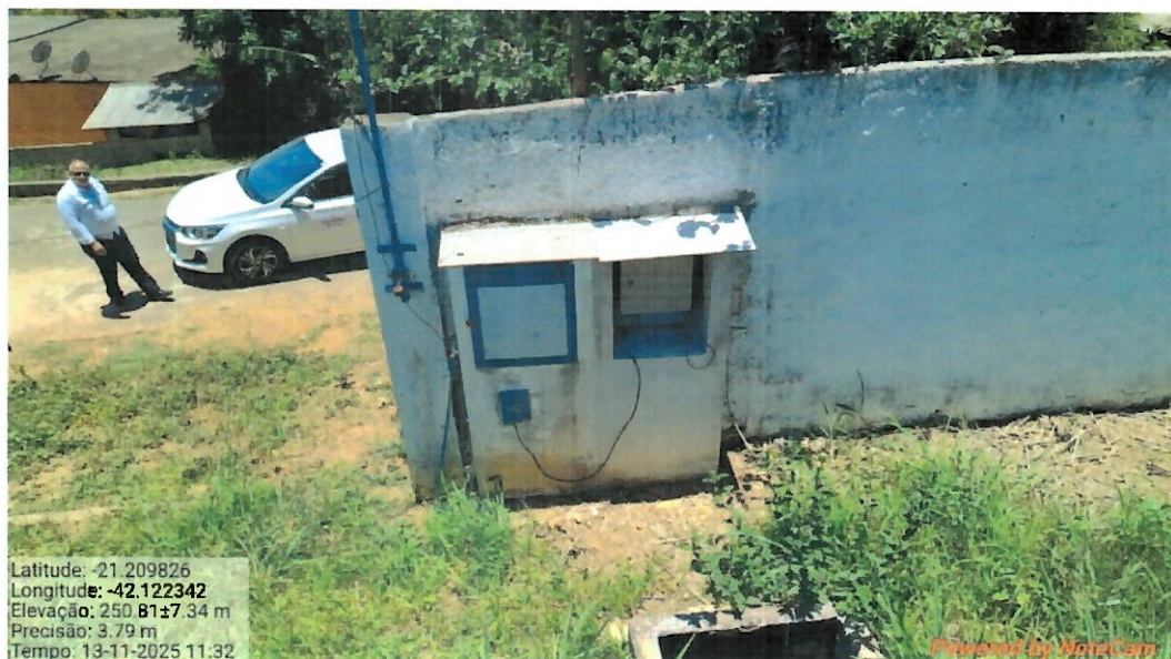
Foto 7 : Controle de nível automático.
