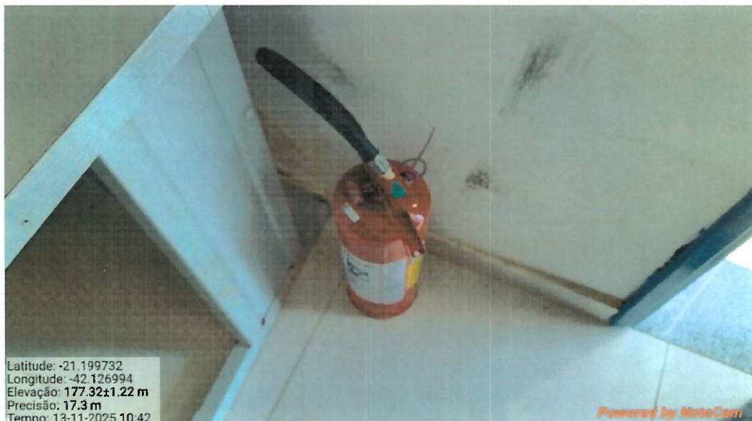
Foto 4: Extintor de incêndio.
