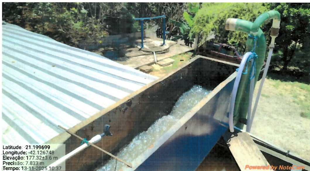
Foto 11: Entrada de água bruta com aplicação de coagulante.
