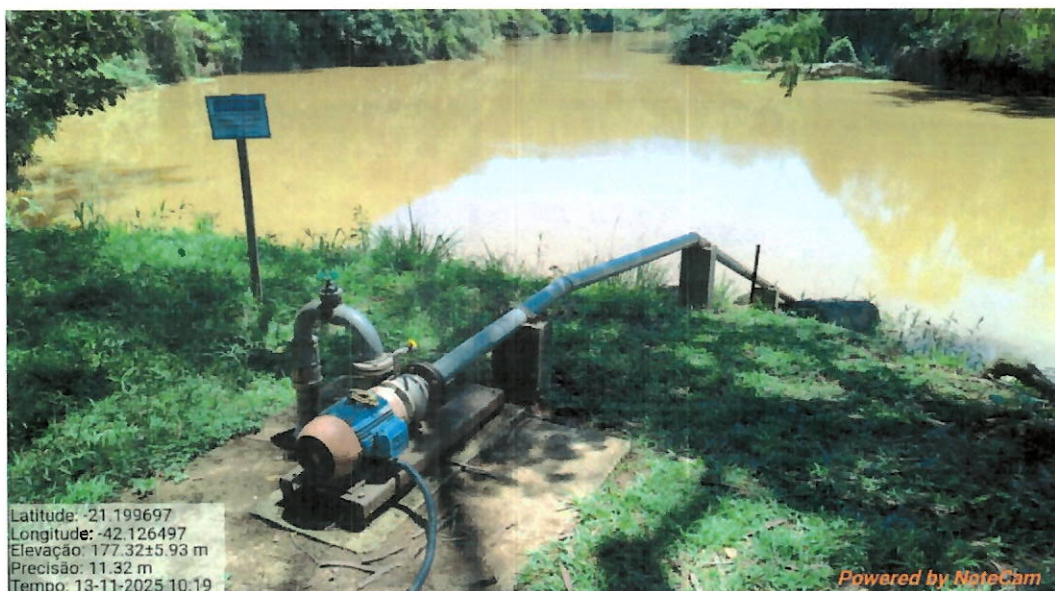
Foto 7: Captação no Rio Muriaé (bomba de 15 cv utilizada quando o nível do rio está baixo).
