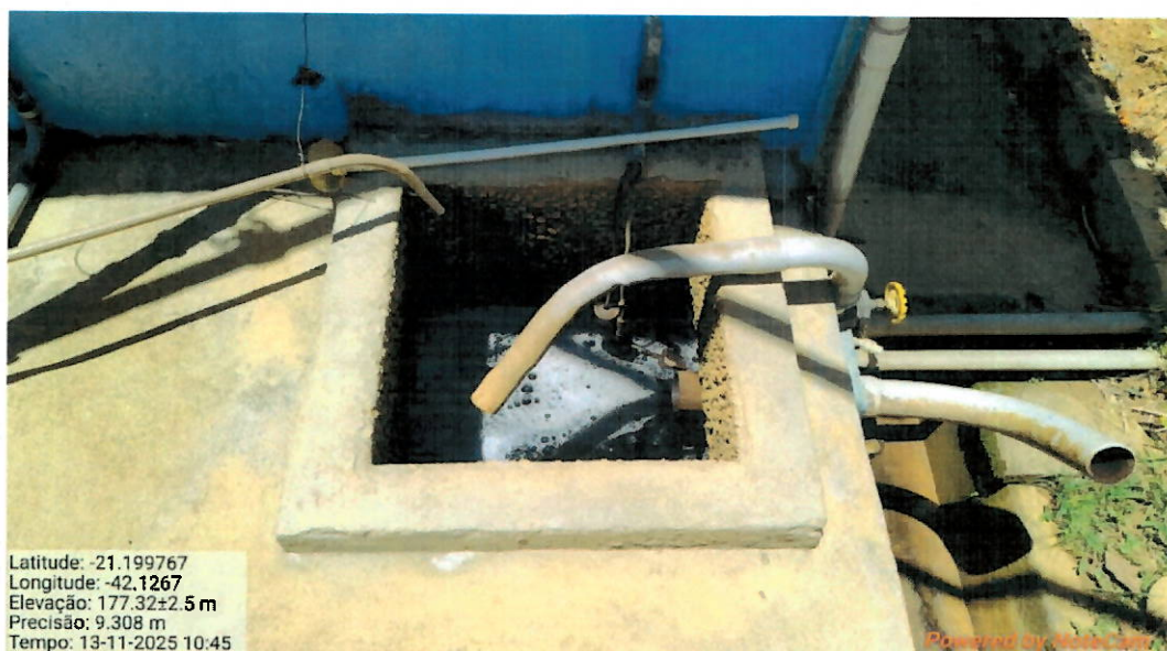
Foto 17: Ausência de tampa estanque sobre o tanque de contato.
