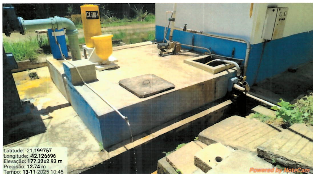
Foto 15: Tanque de cloração.
