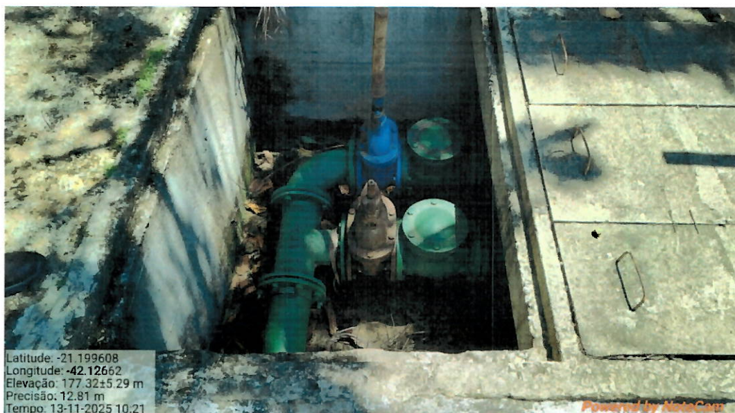
Foto 9: Sistema de captação utilizado quando o nível do rio aumenta (bomba de 15 cv).
