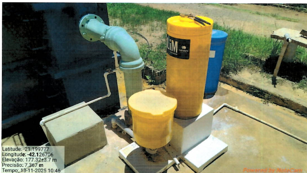
Foto 16: Sistema de cloração.
