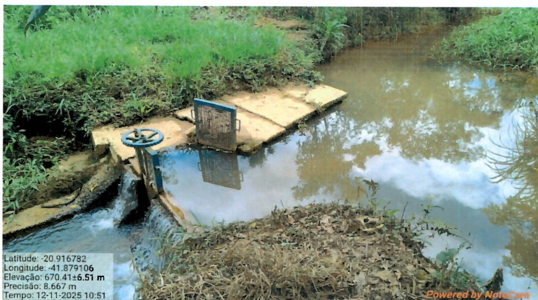
Foto 2: Ponto de captação.
