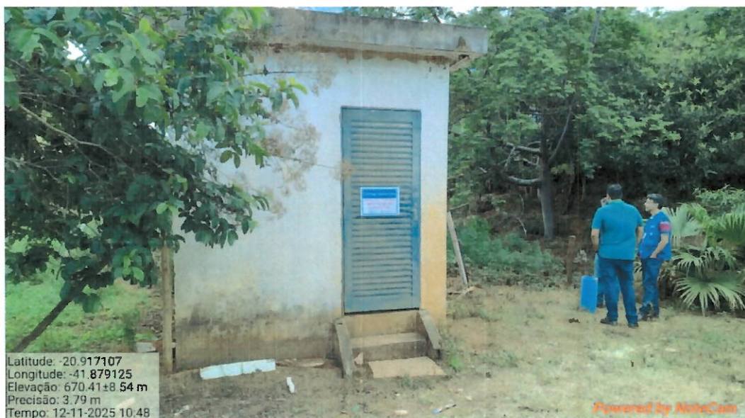
Foto 3: Estação elevatória de água bruta – EEAB.
