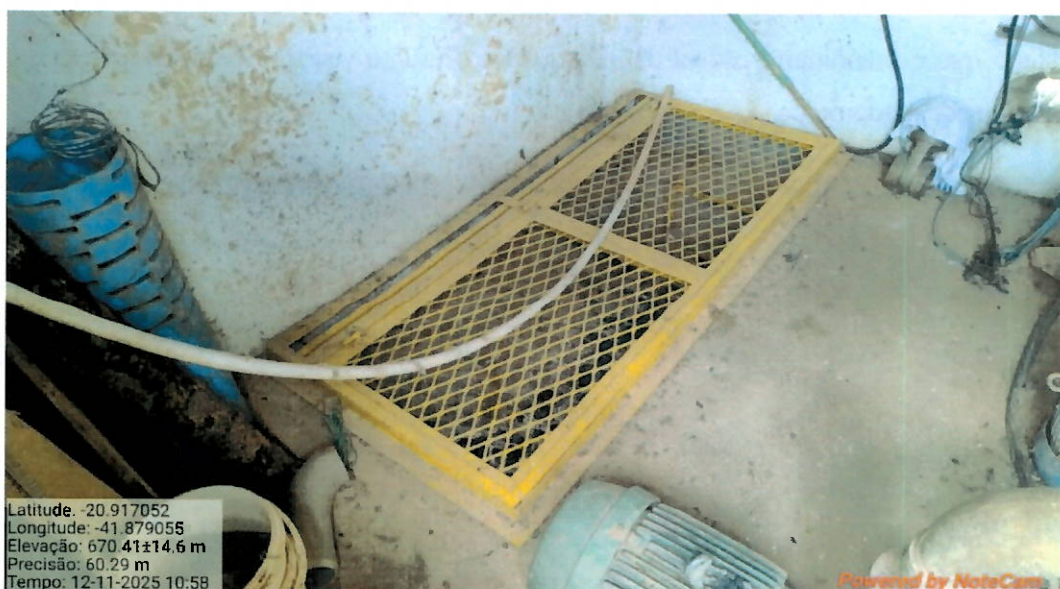
Foto 6: POÇO DE INSPEÇÃO.
