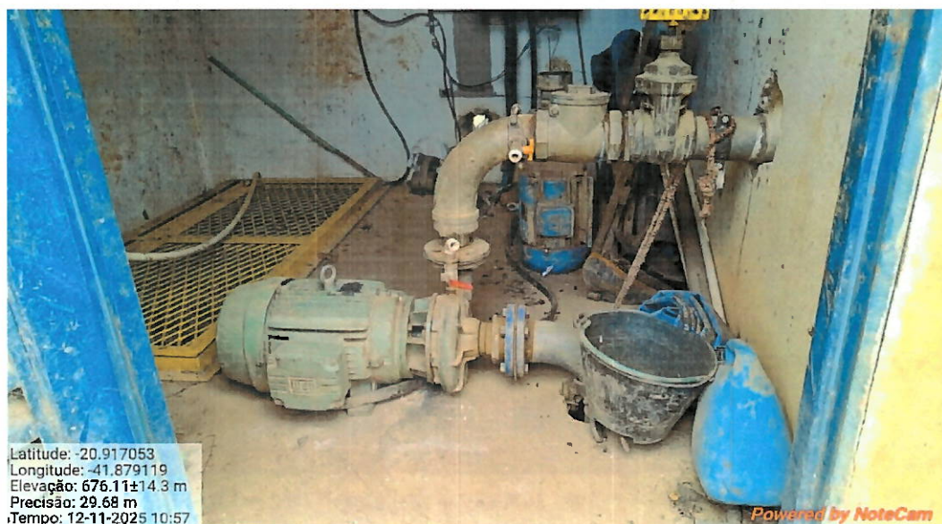
Foto 4: Bomba de 20 cv.
