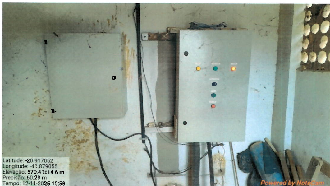
Foto 5: PAINEL ELÉTRICO DA BOMBA.
