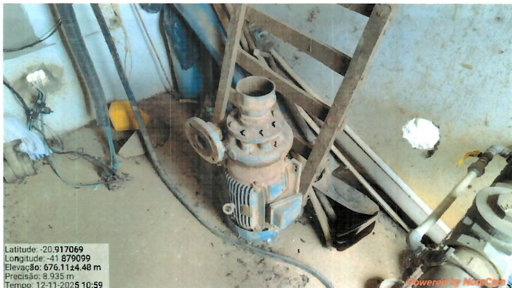
Foto 7: Reserva fria (não instalada).
