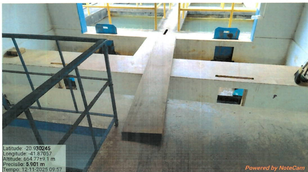
Foto 12: Acesso improvisado sobre os filtros.
