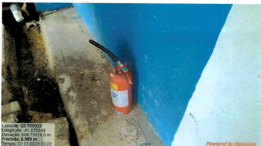
Foto 3: Extintor de incêndio
