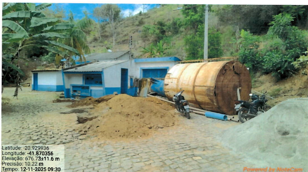
Foto 7: Reservatório que será utilizado para realizar a lavagem dos filtros.
