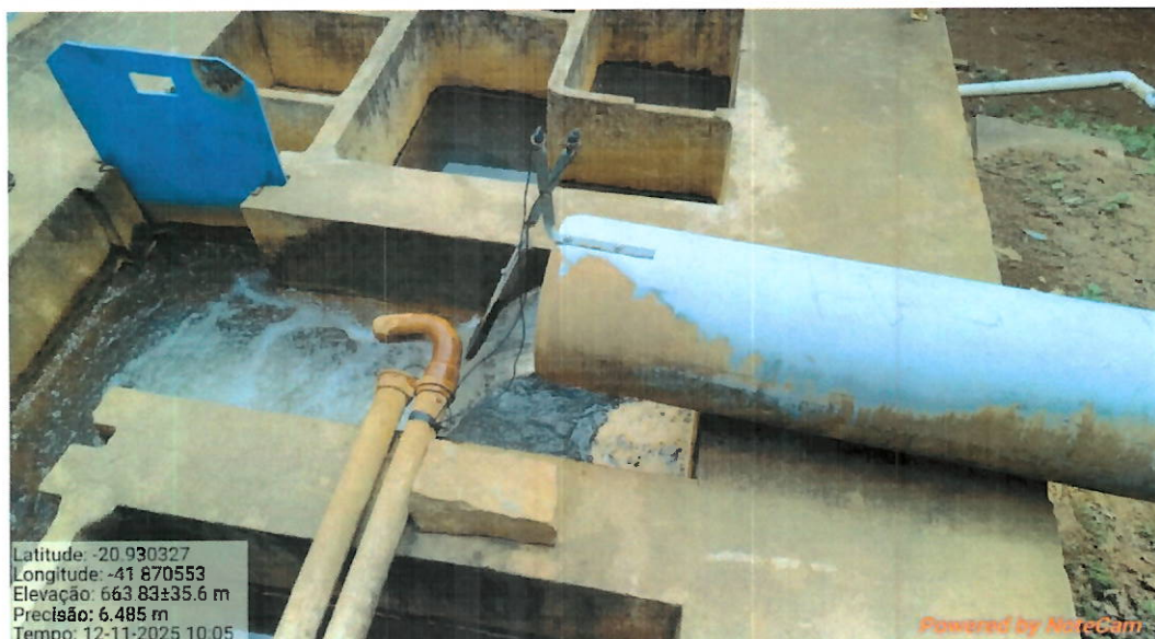
Foto 8: Entrada de água bruta. Nota-se a ausência de medidor de vazão.
