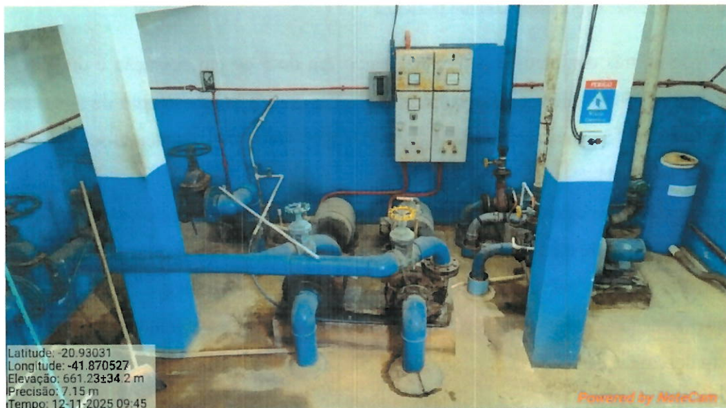
Foto 18: Conjuntos MB utilizados para abastecimento. Quadro elétrico antigo ao fundo (necessidade de substituição para garantir a segurança e eficiência do sistema).
