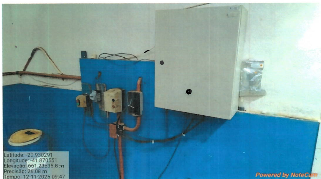
Foto 19: Instalação elétrica inadequada com fiação exposta e ausência de eletrodutos.
