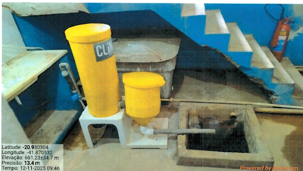
Foto 13: Sistema de cloração com hipoclorito de cálcio (área coberta).
