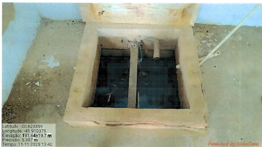
Foto 04 - poço de visita.
