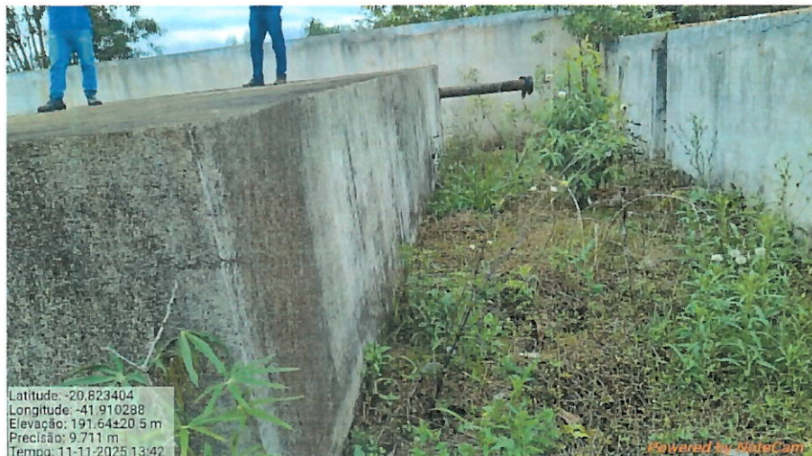
Foto 05- vegetação excessiva no terreno (necessidade de manutenção constante).
