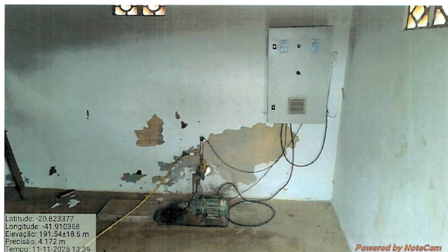
Foto 03 - bomba e painel elétrico
