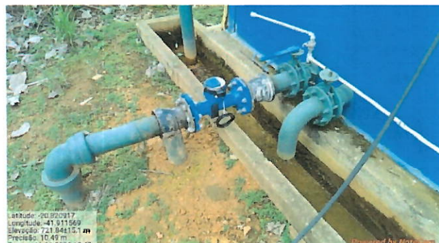
Foto 12 - medidor de vazão
