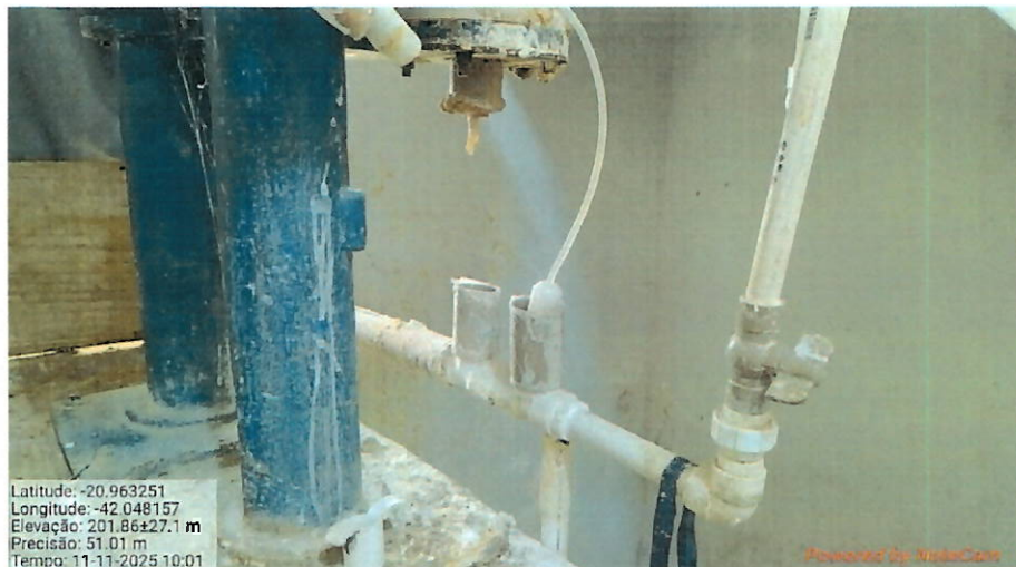
Foto 19- ponto de dosagem de sulfato de alumínio
