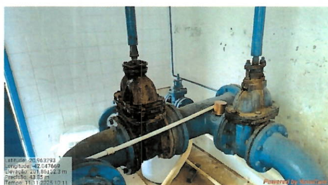
Foto 11 - vazamento em uma válvula.
