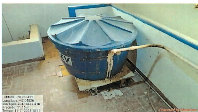
Foto 18 - armazenamento de sulfato de alumínio (sem bacia de contenção)
