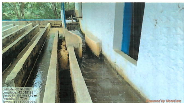
Foto 06 - entrada de água bruta na calha Parshall.
