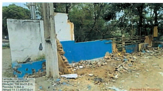
Foto 06 - muro quebrado em uma das laterais.
