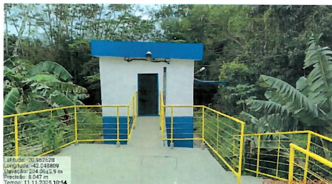
Foto 03 - elevatória de água bruta.
