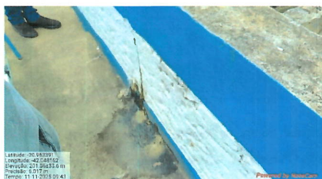
Foto 10 - infiltração na lateral do flocculador.
