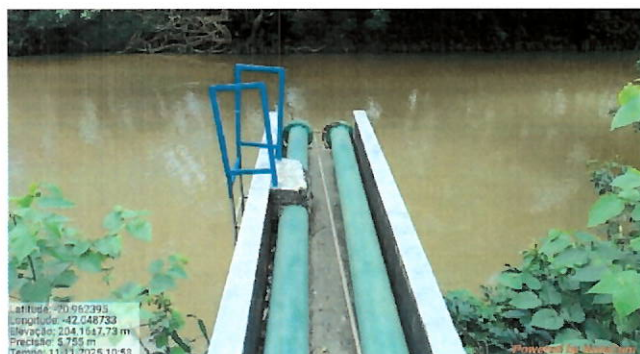
Foto 02 - adutora de captação da água bruta.
