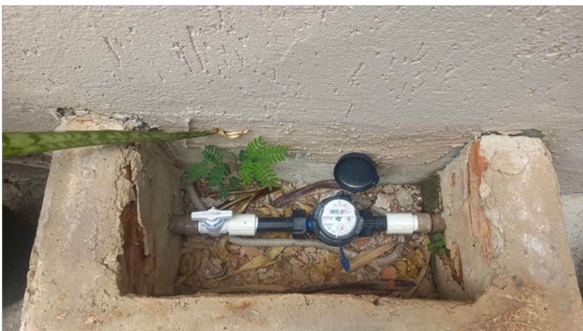
Figura 7: Hidrômetro do imóvel da reclamante
