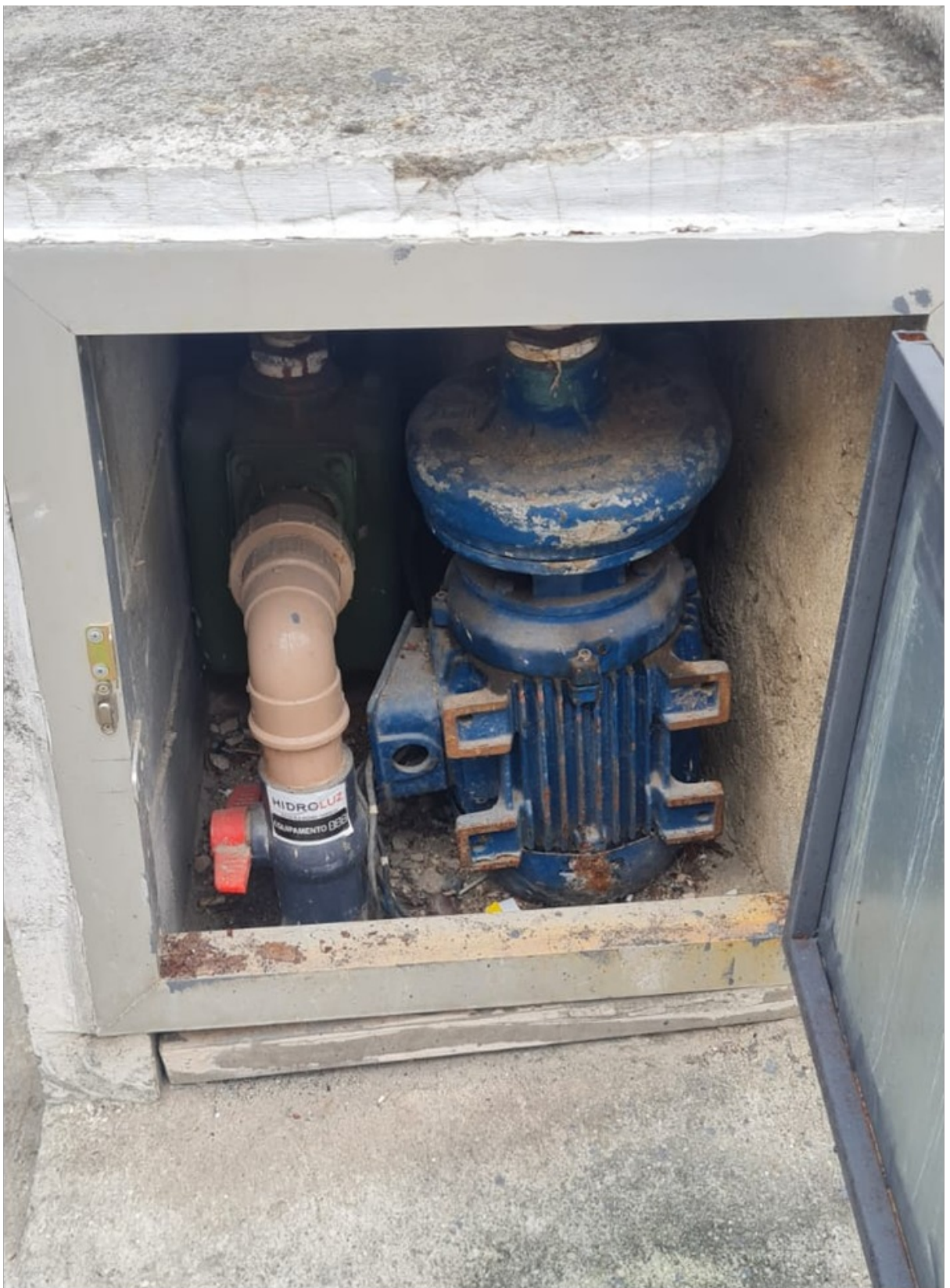
Figura 5: Elevatória do logradouro
