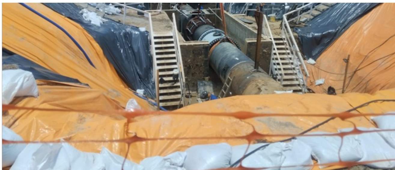
Foto 02- Macromedidor 5ª linha.
