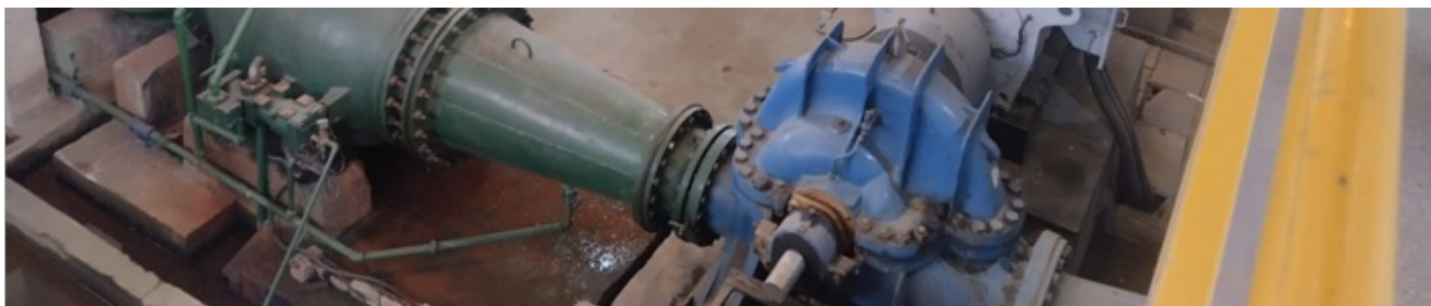
Foto 04 –Galeria de bombas do Alto Recalque do Guandu – ARG.
