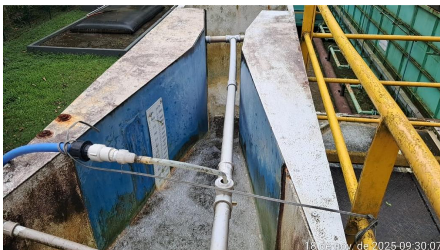
Foto 03 - Medidor de vazão e aplicação de coagulante PAC
