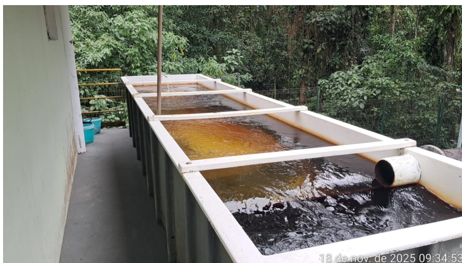
Foto 02 - Entrada de água bruta; início do tratamento
