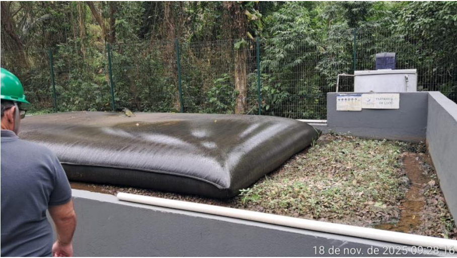
Foto 11 - Geobag para armazenamento de lodo gerado pelo tratamento
