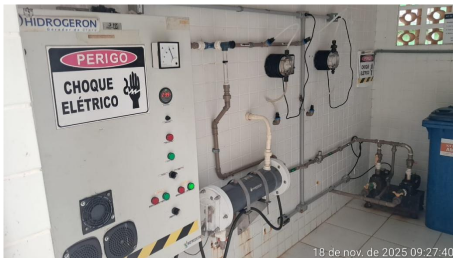
Foto 07 - Gerador de hipoclorito; gerado por eletrólise
