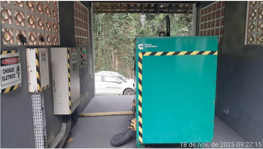
Foto 10 - Gerador elétrico; atuação em caso de falta de energia
