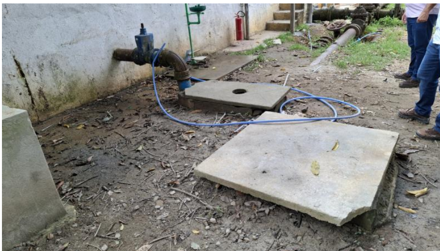
Foto 07 - Tubulação de distribuição
