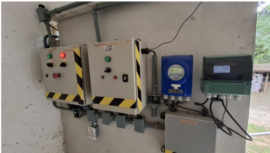
Foto 04 - Macromedidor de saída
