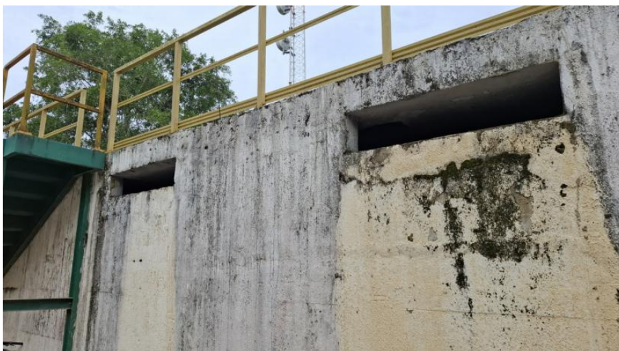
Foto 03 - Saída de ventilação do reservatório
