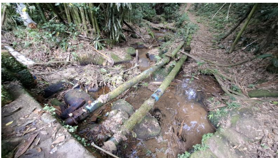
Foto 02 - Tubulação de saída para o Reservatório
