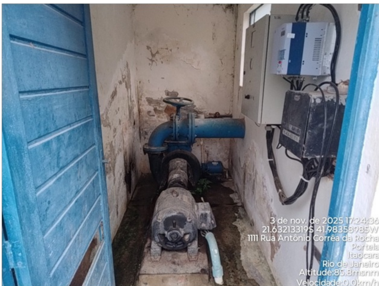
Foto 20: Bomba da EEAT.
