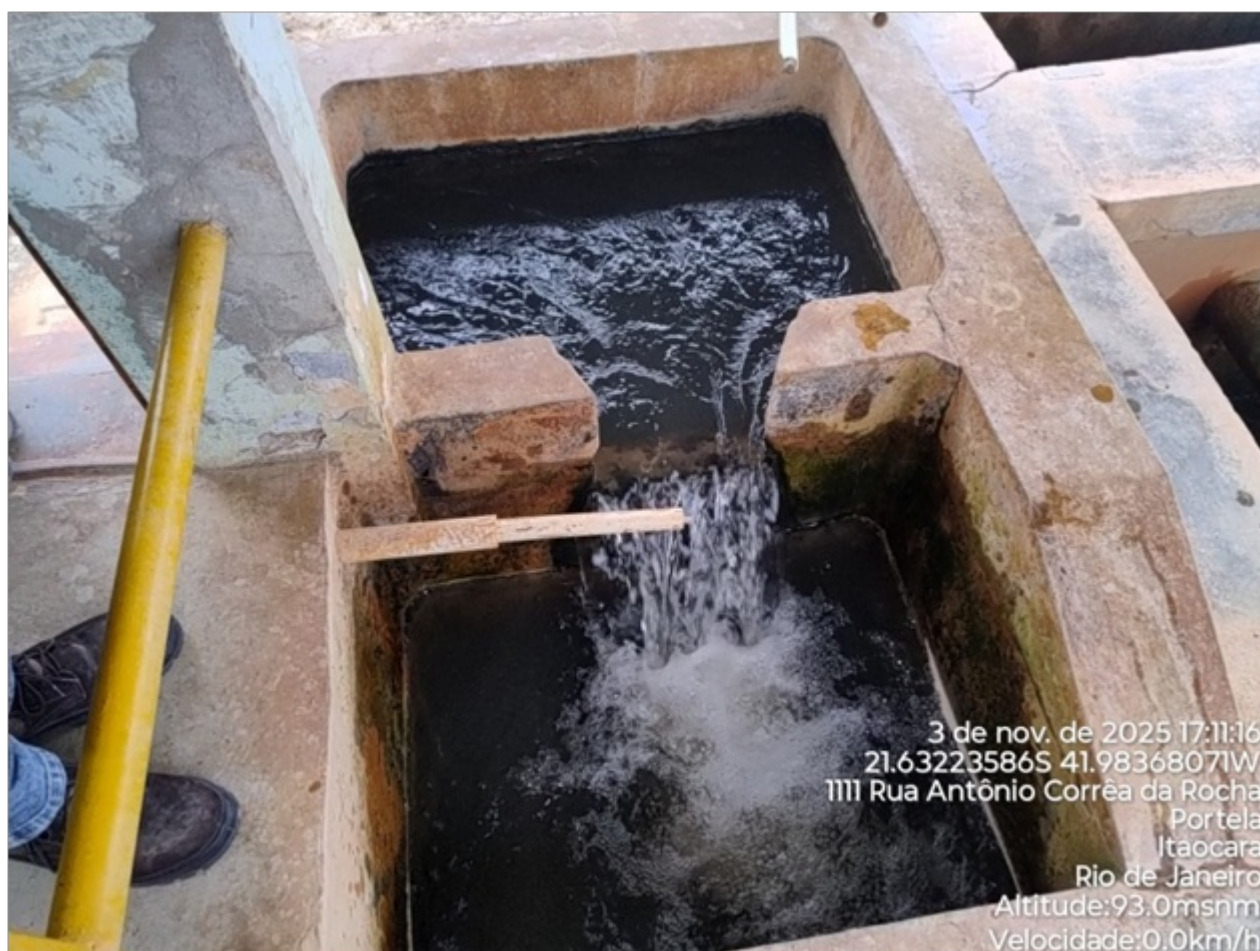
Foto 06: Chegada da água bruta e aplicação do agente coagulante.
