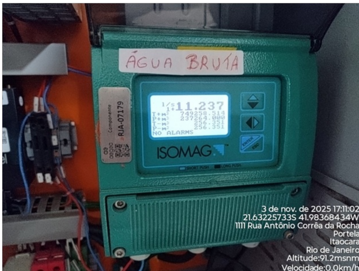
Foto 05: Macromedidor de água bruta.
