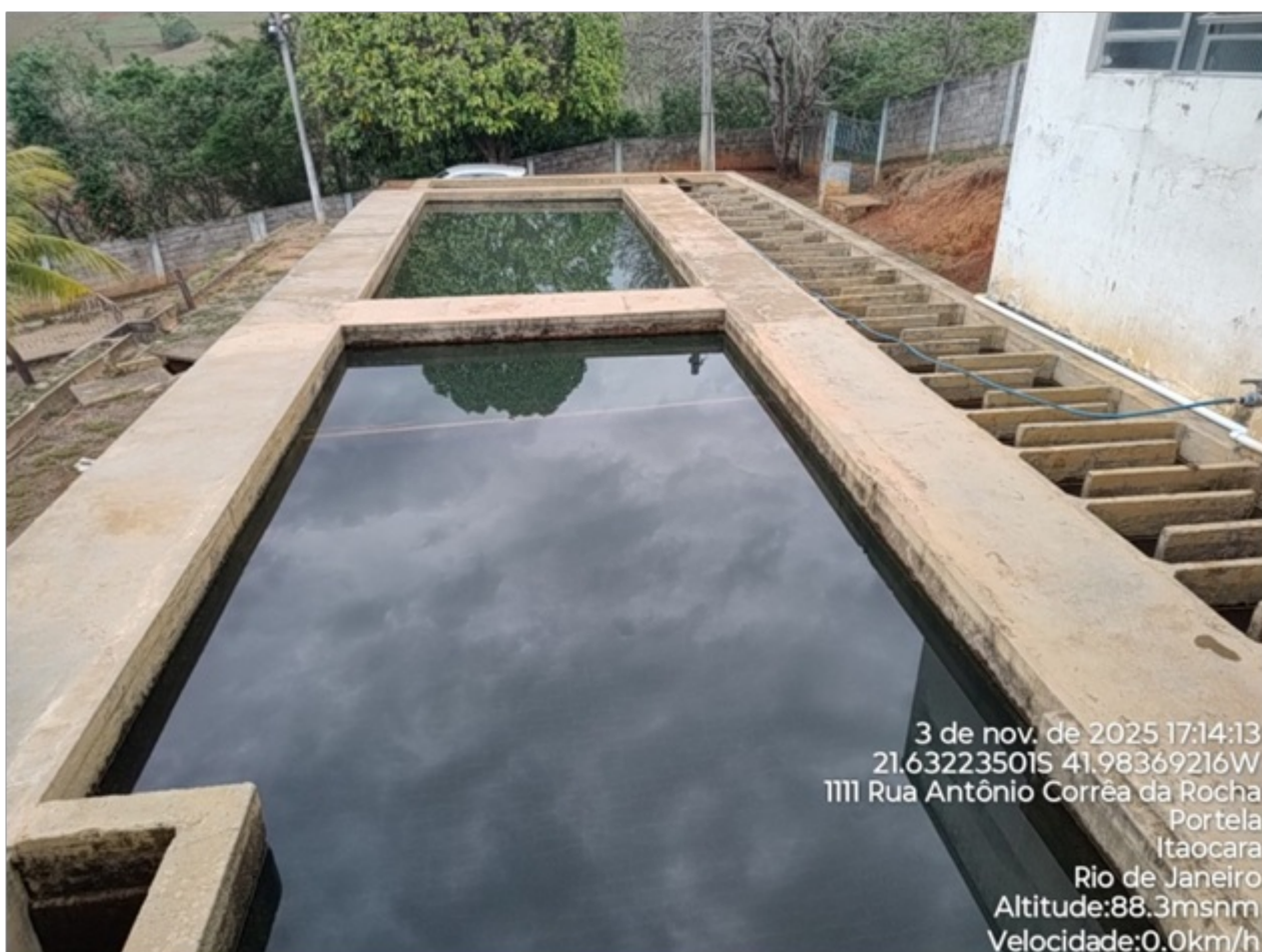
Foto 10: Ausência de guarda-corpo nos tanques de tratamento.
