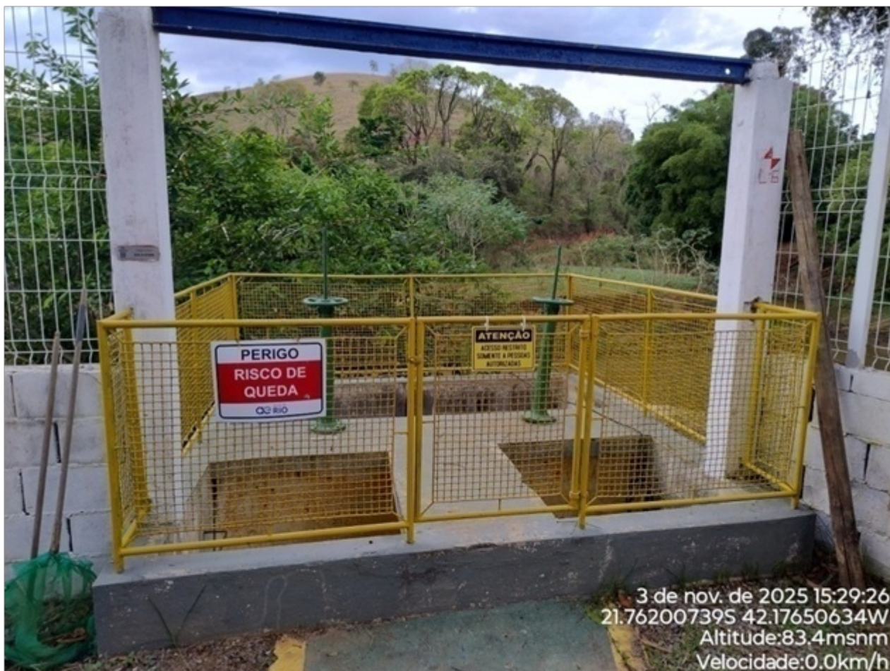
Foto 03: Captação de água bruta.
