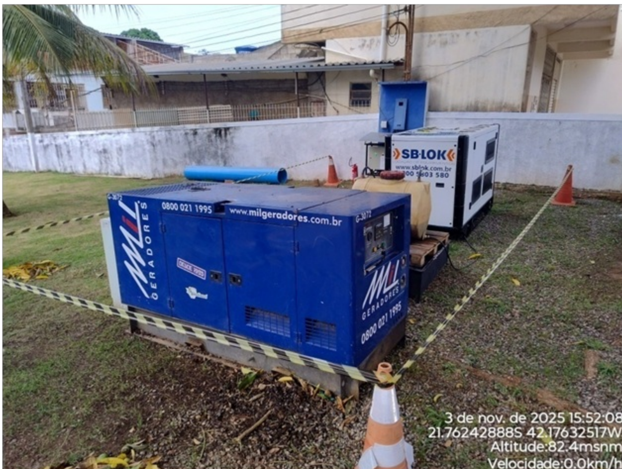
Foto 20: Gerador de energia elétrica em caso de interrupção no fornecimento da distribuidora.
