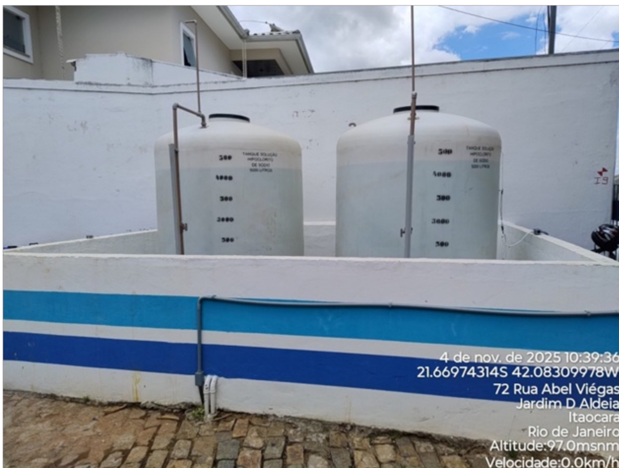
Foto 15: Tanques de armazenamento de Hipoclorito de sódio.
