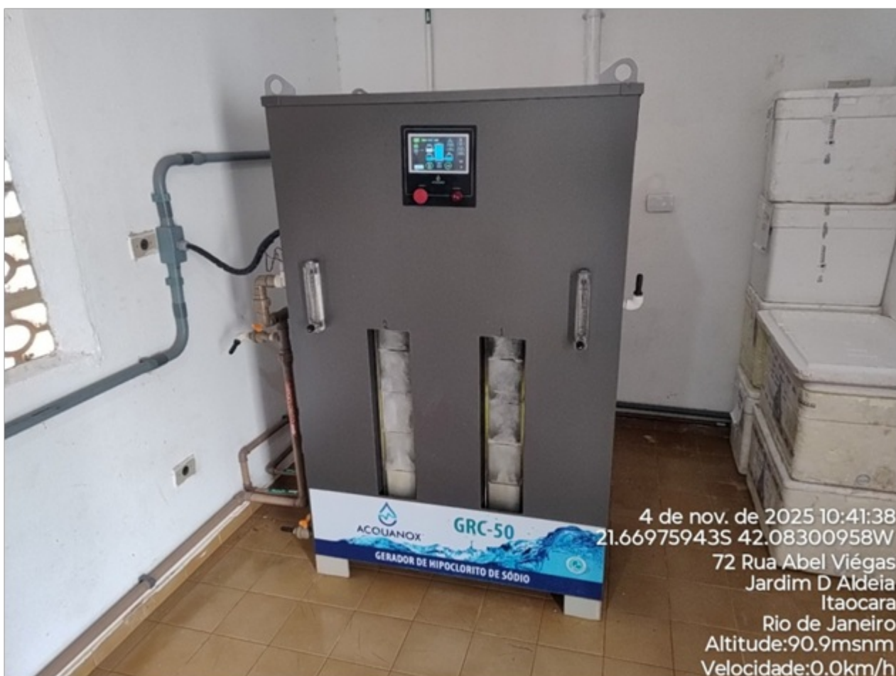
Foto 12: Equipamento gerador de Hipoclorito de sódio.
