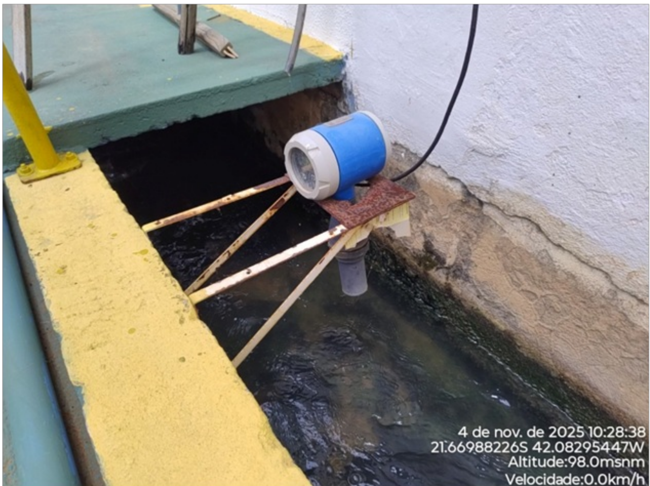
Foto 04: Medidor de vazão de água bruta.
