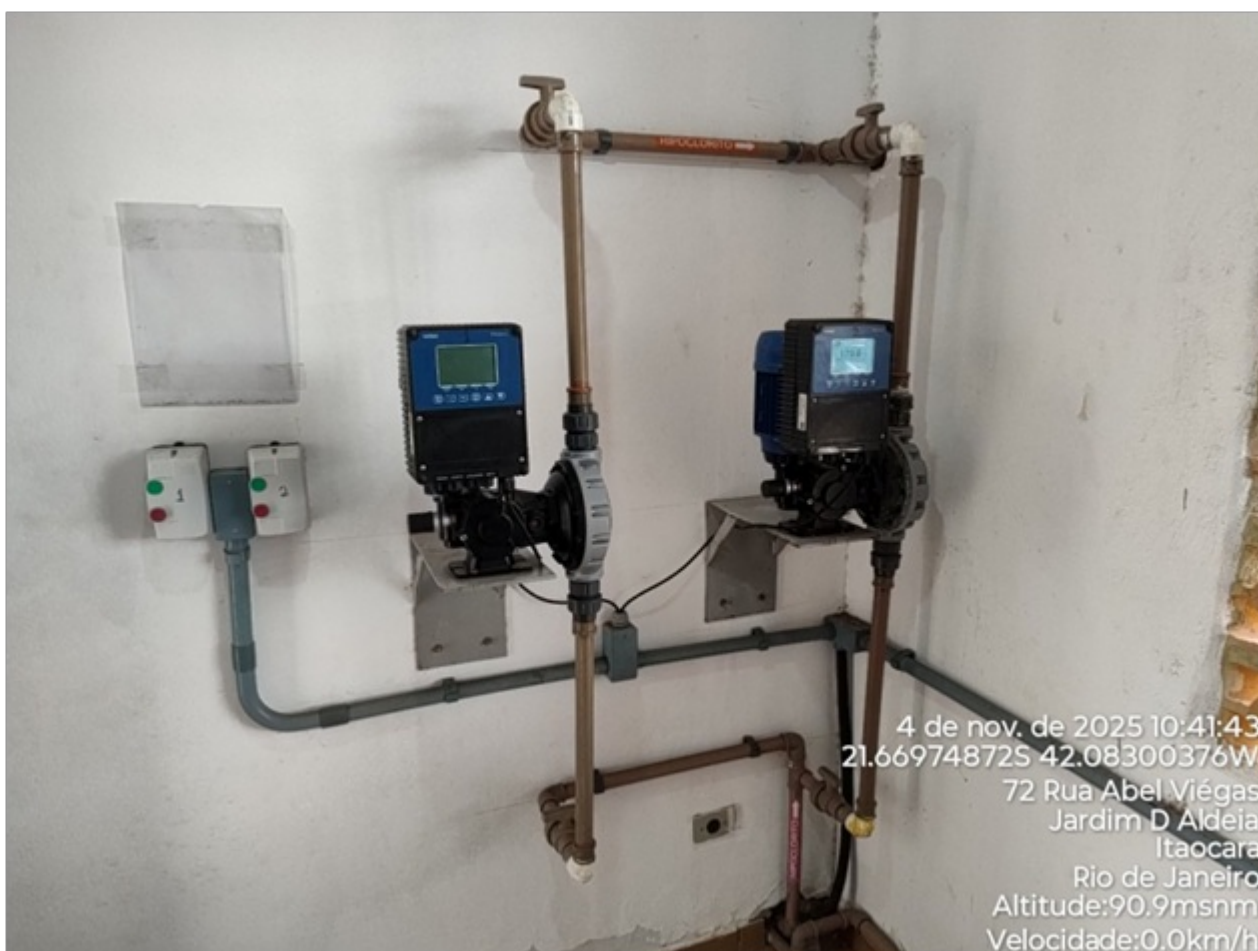
Foto 16: Dosador de Hipoclorito de sódio.
