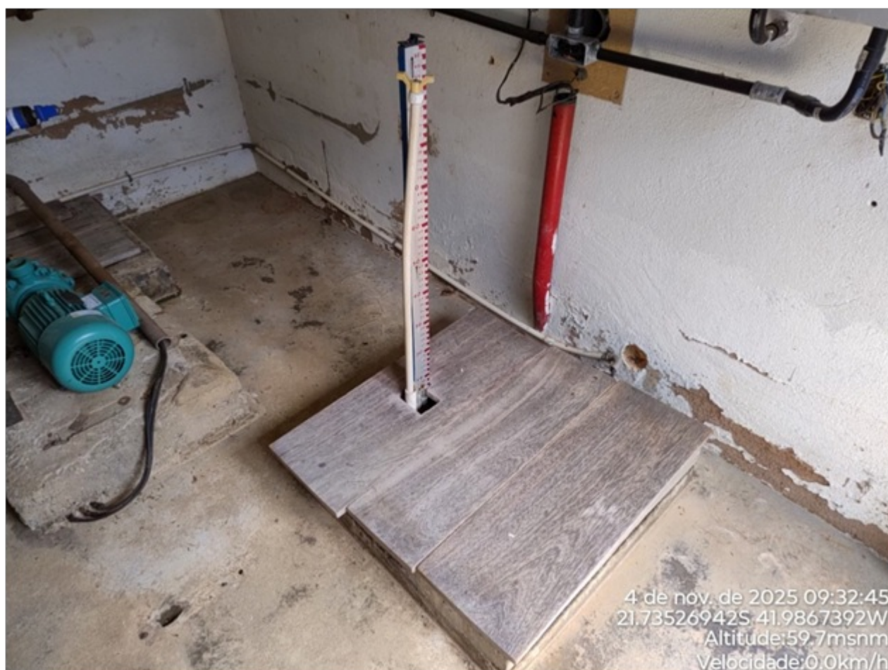
Foto 21: Reservatório de água tratada.
