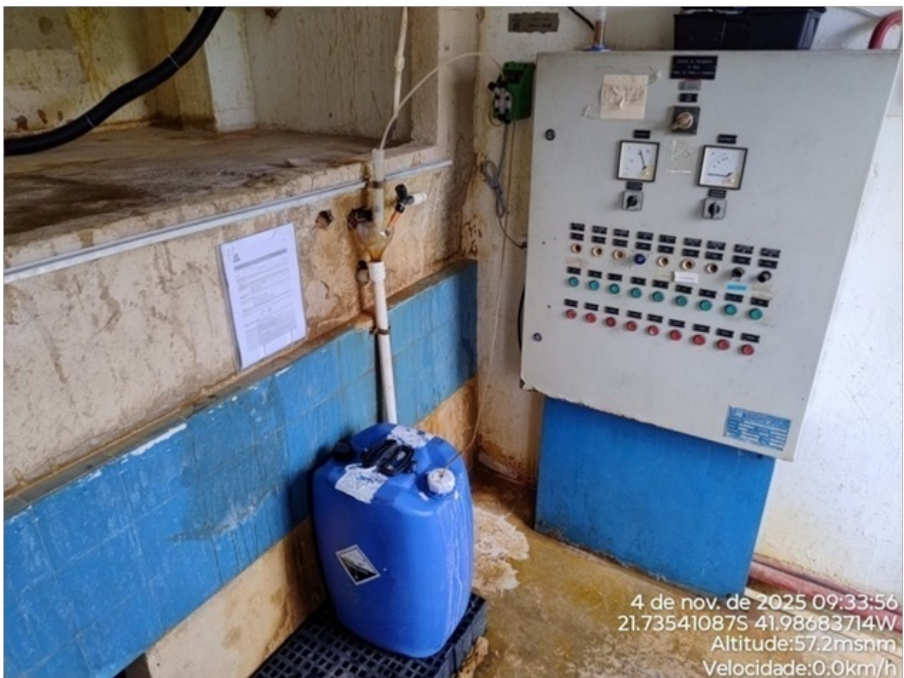
Foto 14: Dosador de Sulfato de alumínio (agente coagulante).
