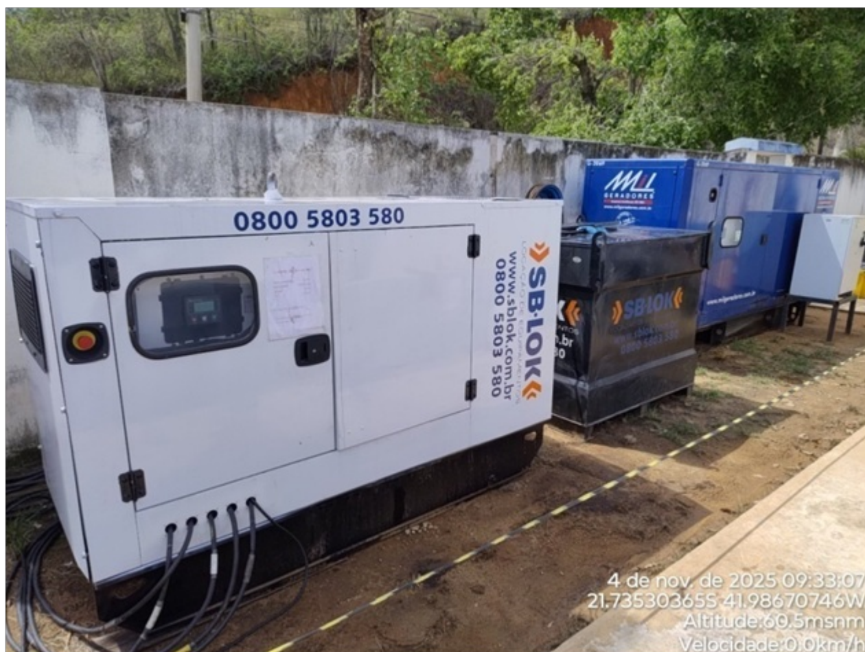
Foto 22: Gerador de energia elétrica em caso de interrupção no fornecimento da distribuidora.
