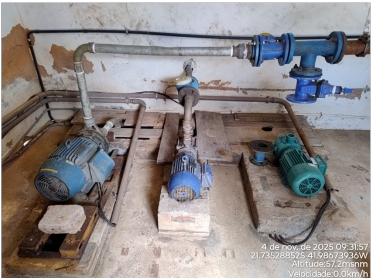
Foto 18: Bombas da EEAT e da lavagem de filtros.
