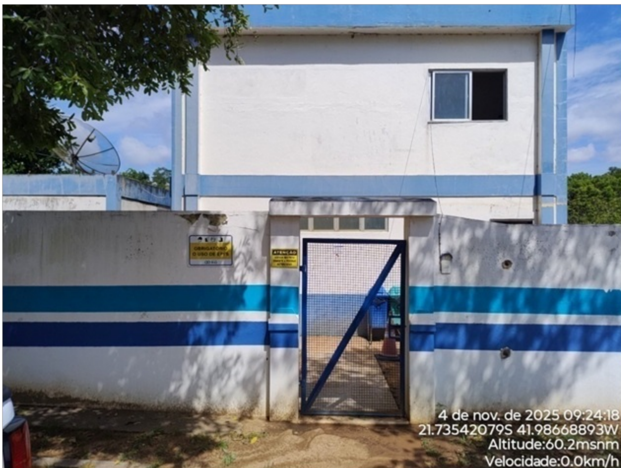
Foto 01: Entrada da ETA sem identificação da unidade.
