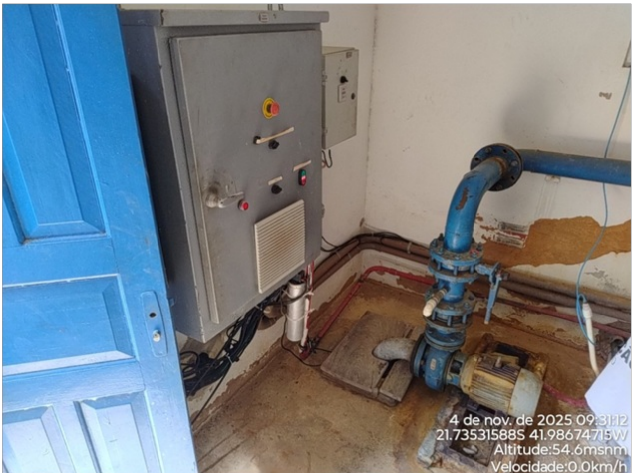
Foto 19: Painel de comando da EEAT.
