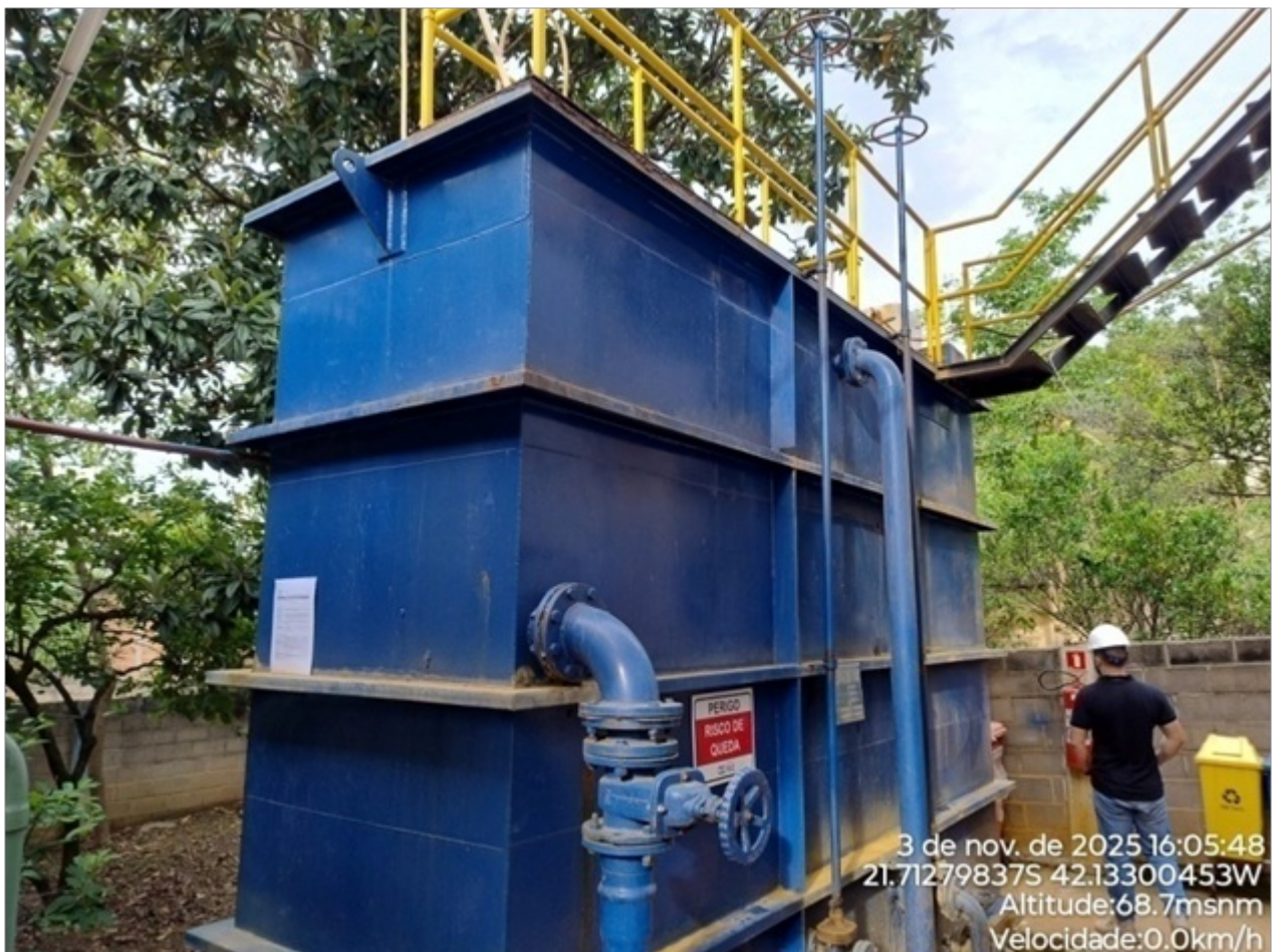
Foto 02: Módulo de tratamento.
