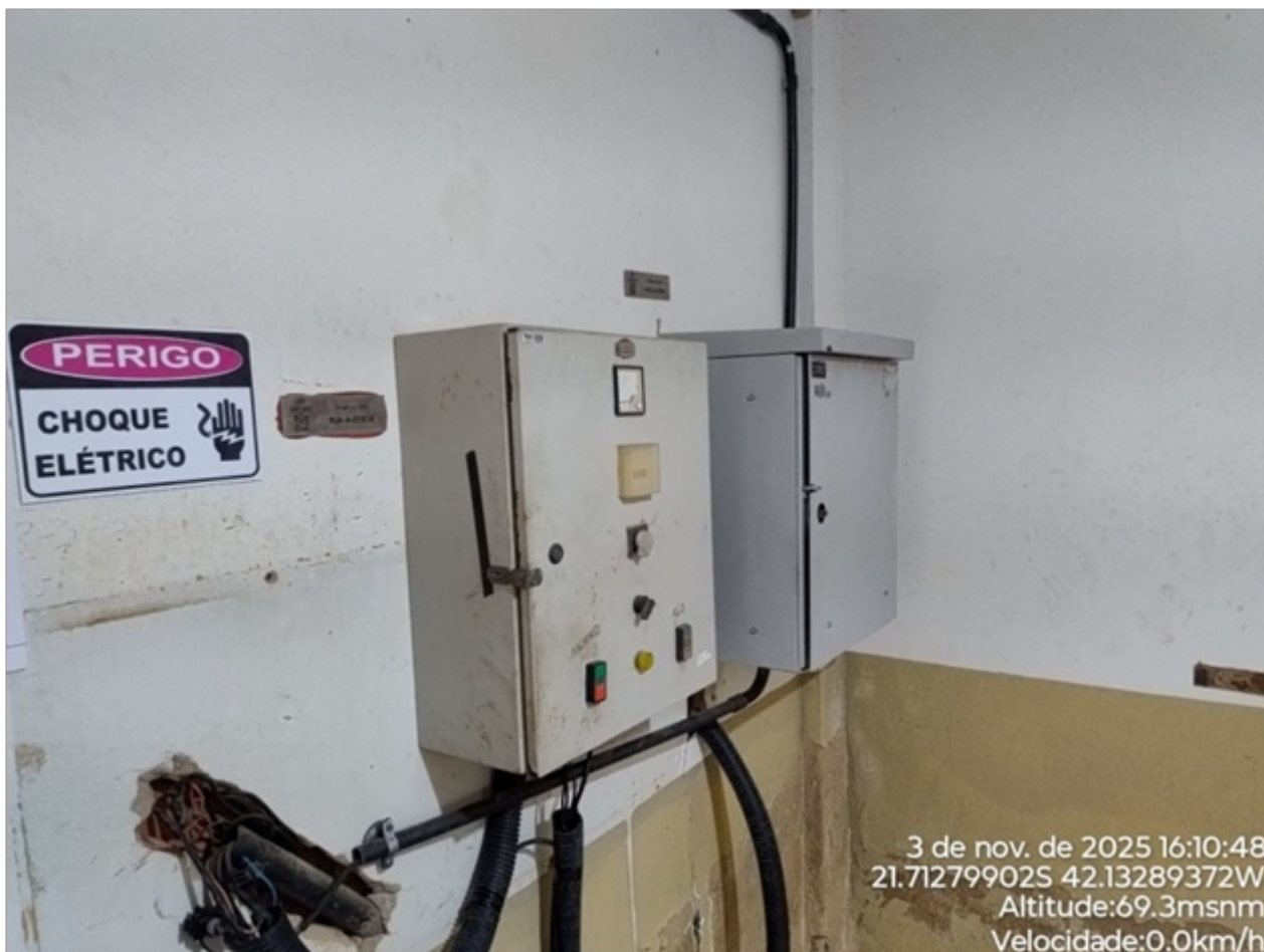
Foto 16: Painel de comando da EEAT.
