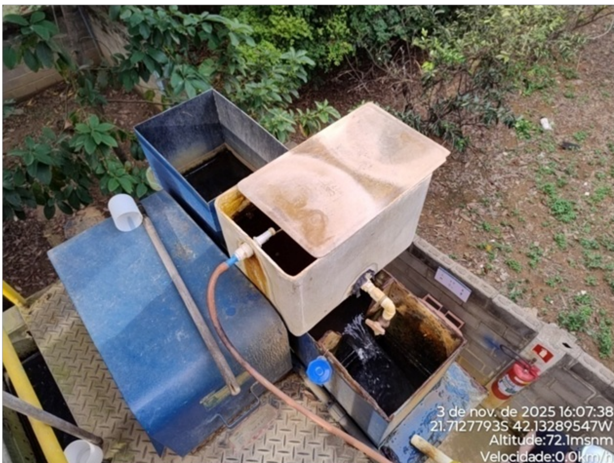
Foto 04: Chegada da água bruta e aplicação do agente coagulante.
