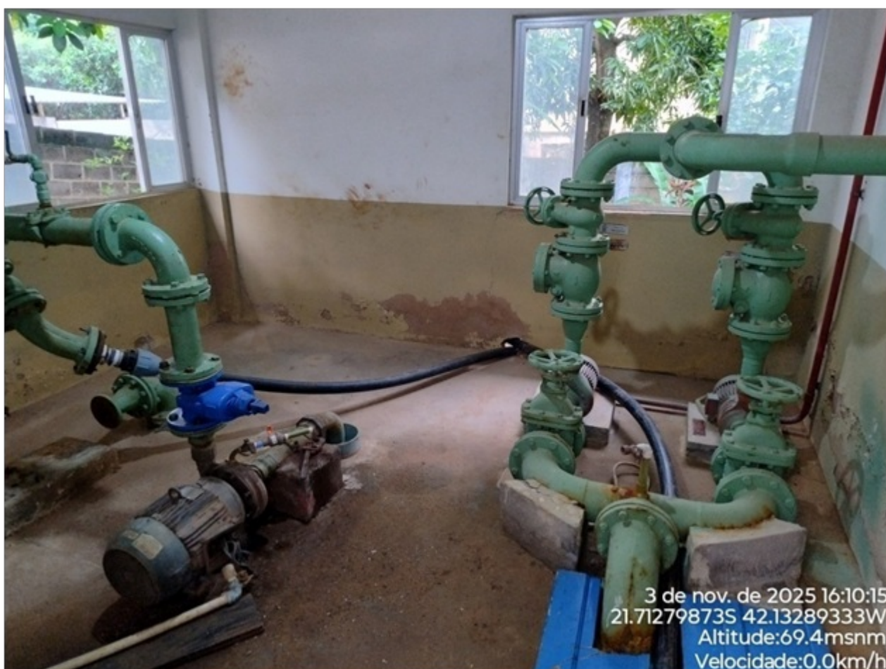
Foto 15: Bombas da EEAT e da lavagem de filtros.
