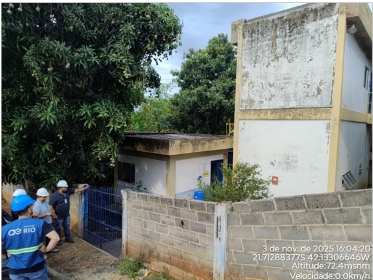
Foto 01: Entrada da ETA sem identificação da unidade.
