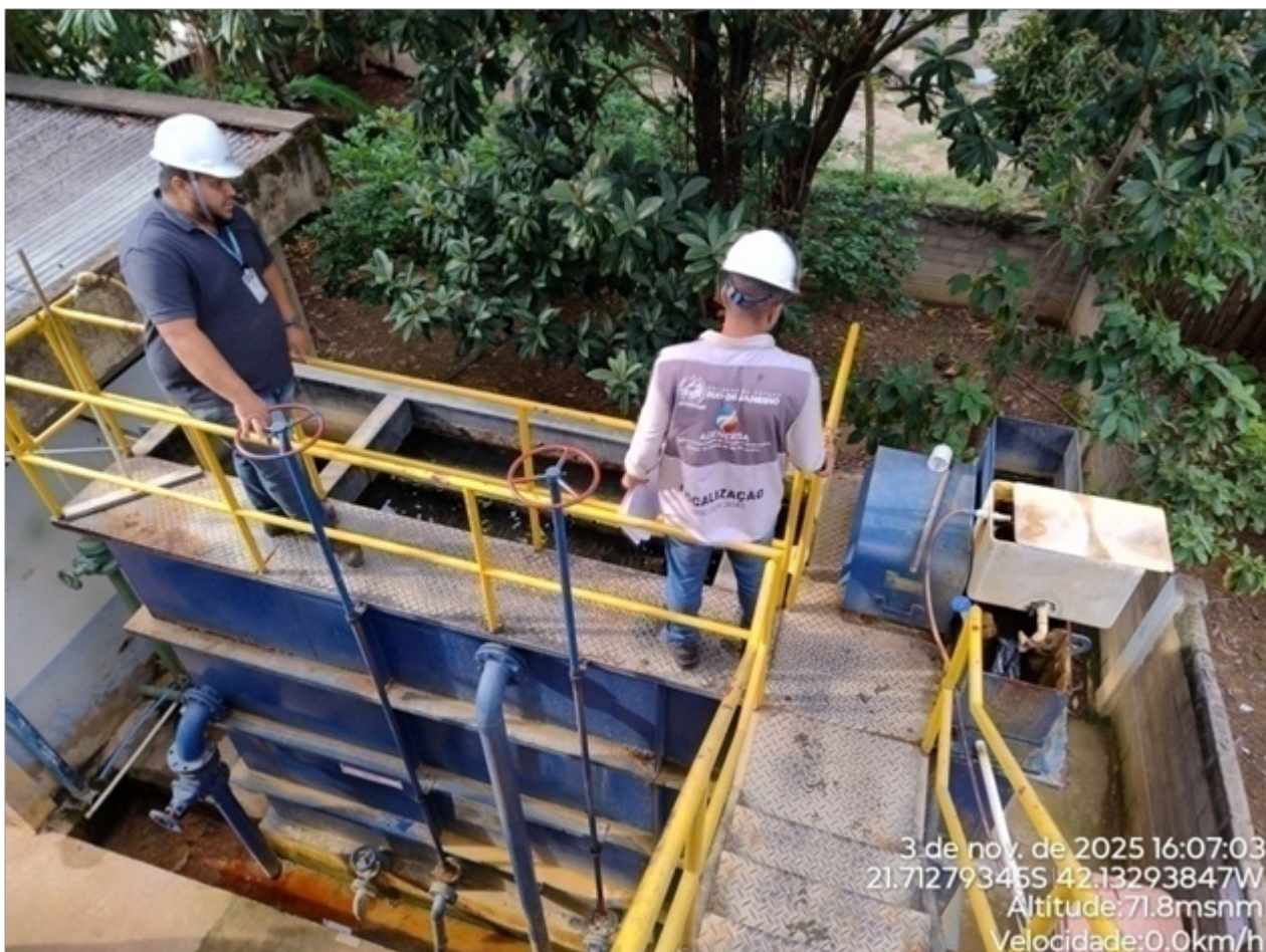
Foto 03: Módulo de tratamento.
