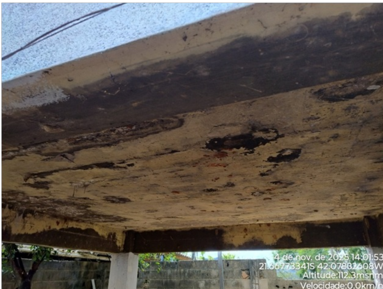
Foto 10: Laje de fundo do reservatório com ferragem da armadura aparente.
