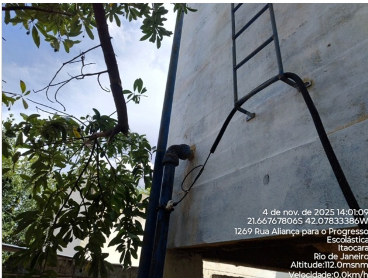
Foto 06: Tubulações e medidores.
