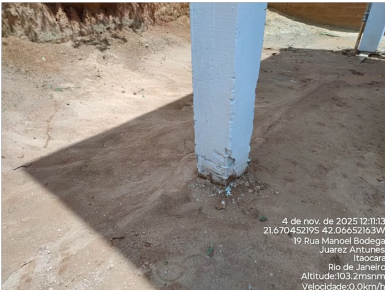
Foto 09: Ferragem da armadura exposta.
