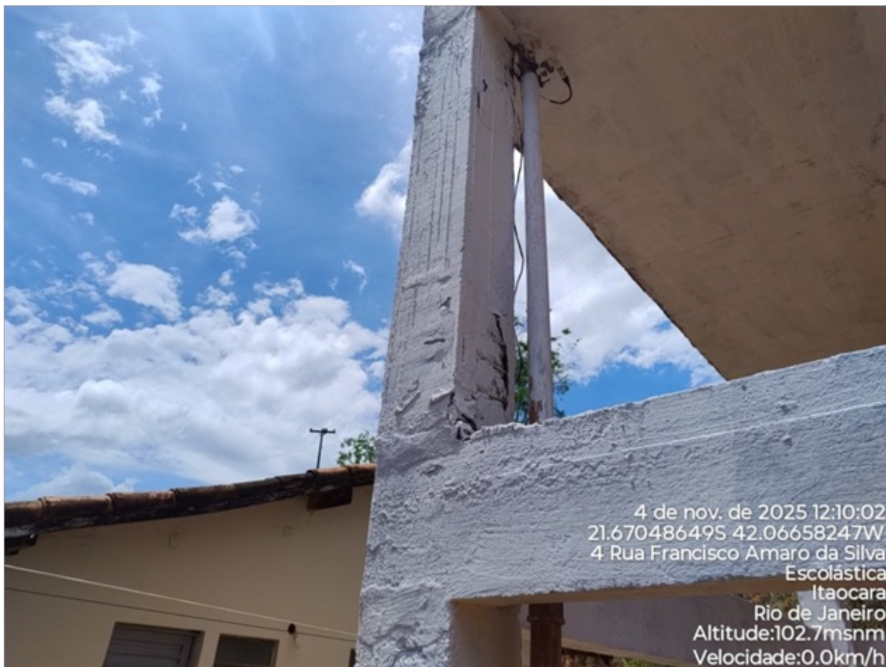
Foto 08: Ferragem da armadura exposta.
