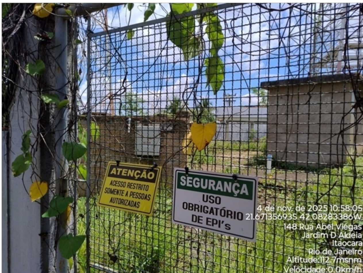
Foto 02: Reservatório isolado e com acesso restrito.
