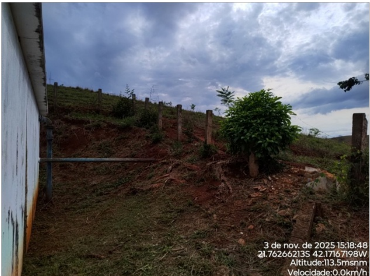
Foto 08: Isolamento e cercamento precários.
