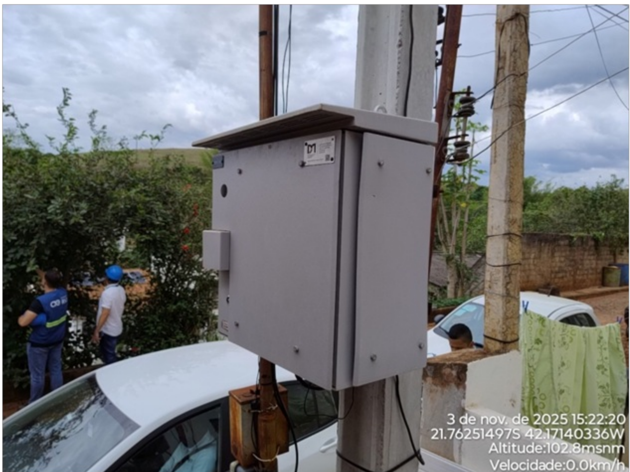
Foto 07: Equipamento de telemetria e controle.
