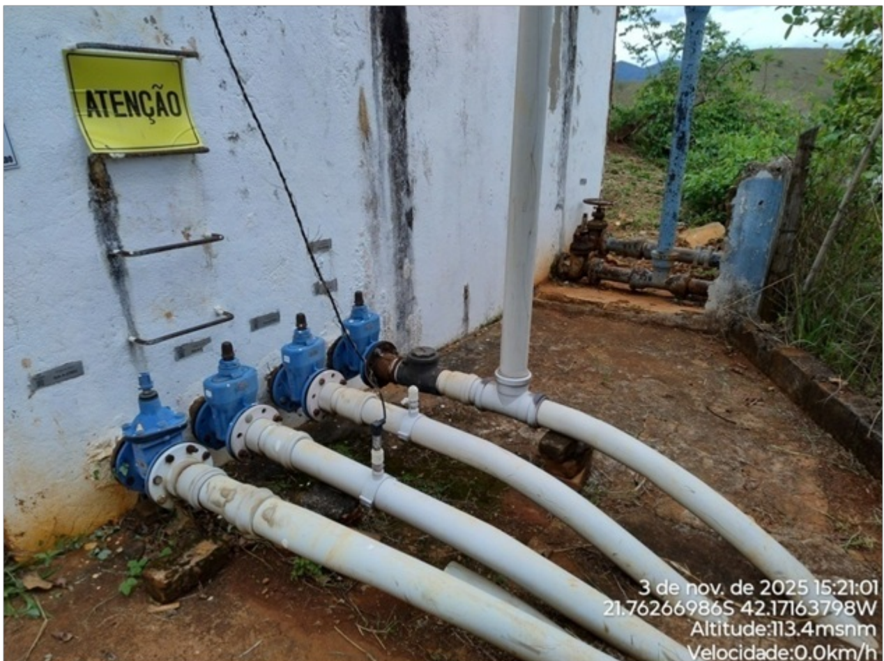
Foto 05: Tubulações de saída com 150 mm DN.
