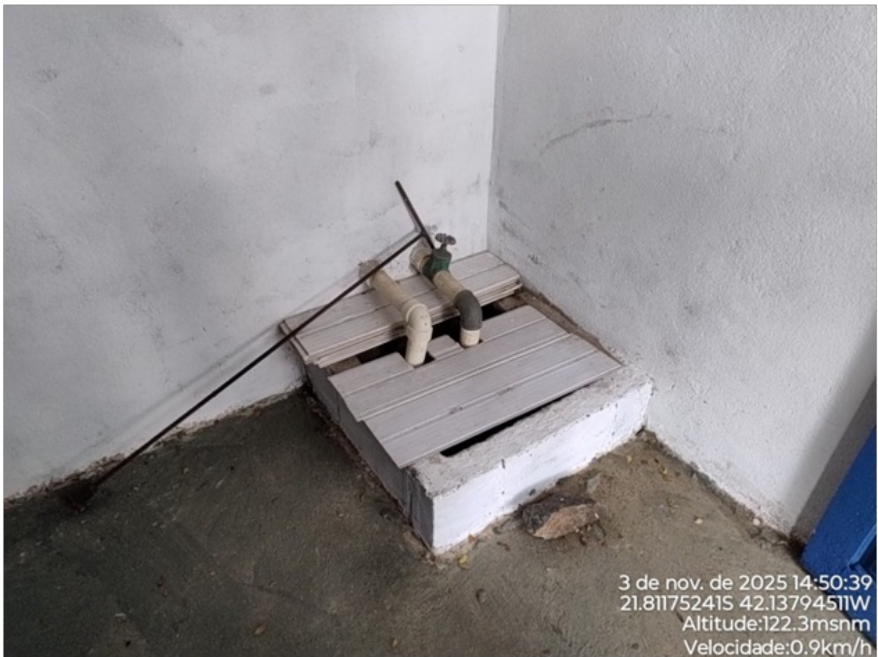
Foto 04: Tubulação de entrada do reservatório.
