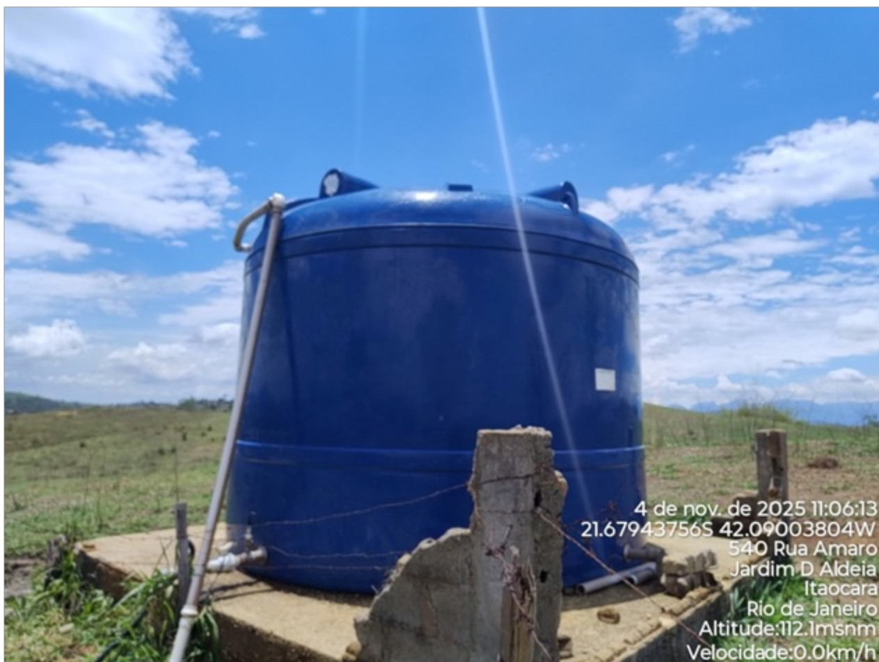
Foto 02: Vista do reservatório sem isolamento e restrição de acesso.
