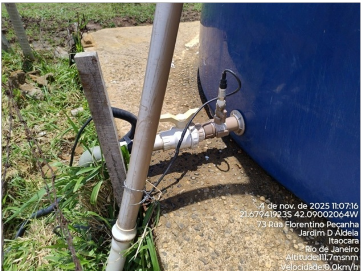
Foto 04: Sensor de telemetria e controle.
