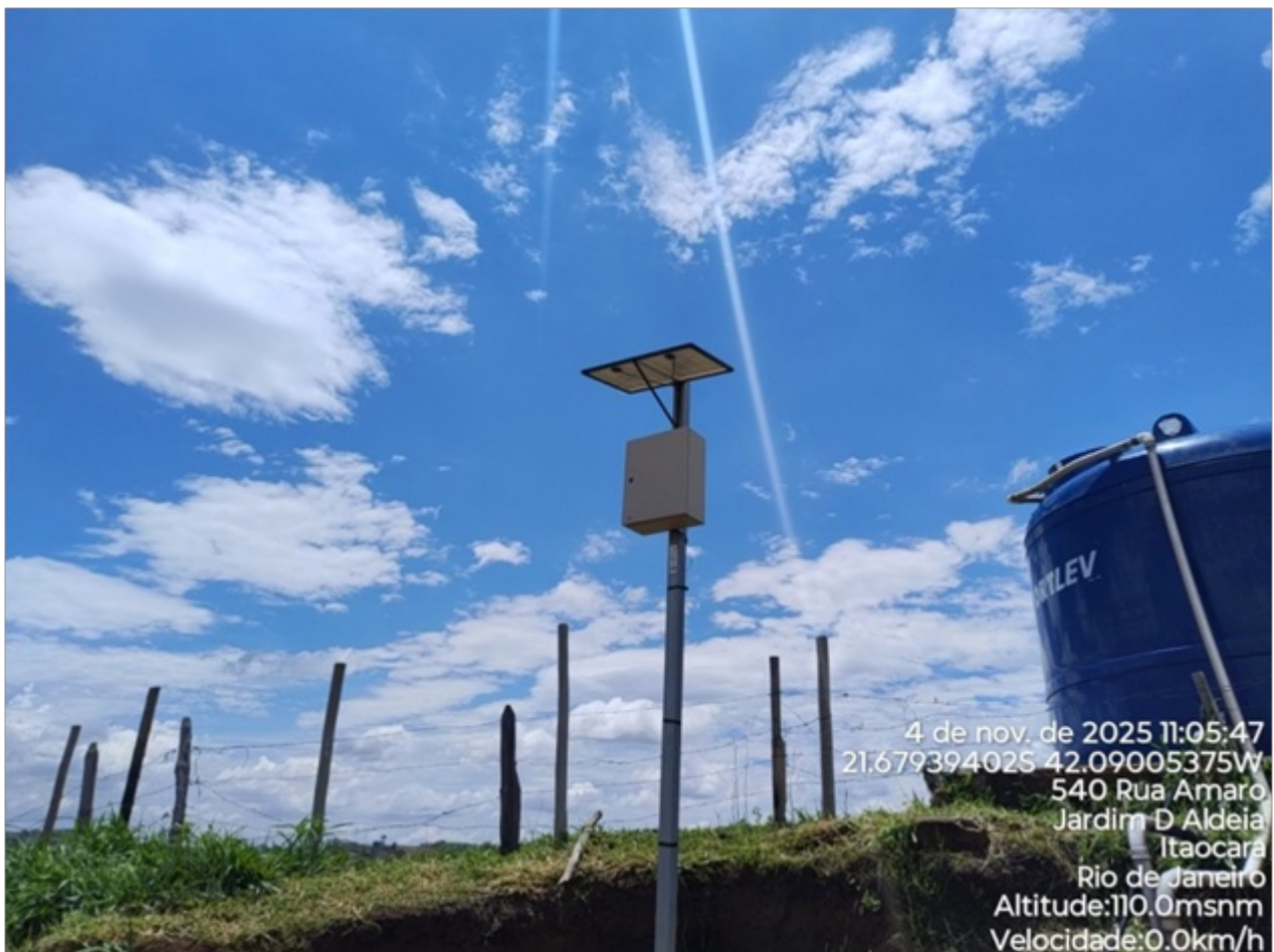
Foto 05: Equipamento de telemetria e controle.
