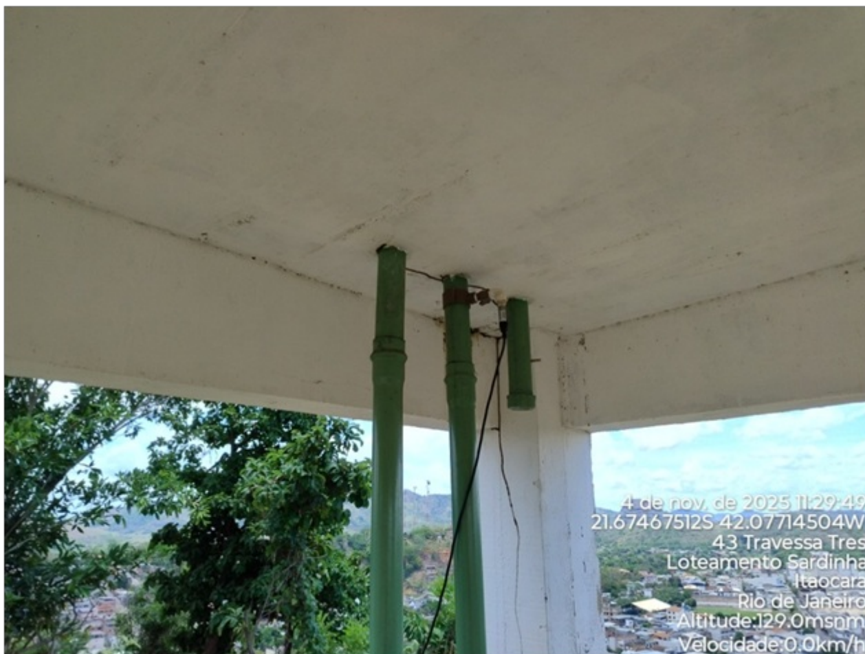
Foto 05: Tubulações de limpeza.
