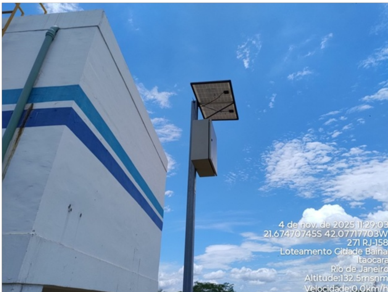
Foto 06: Equipamento de telemetria e controle.
