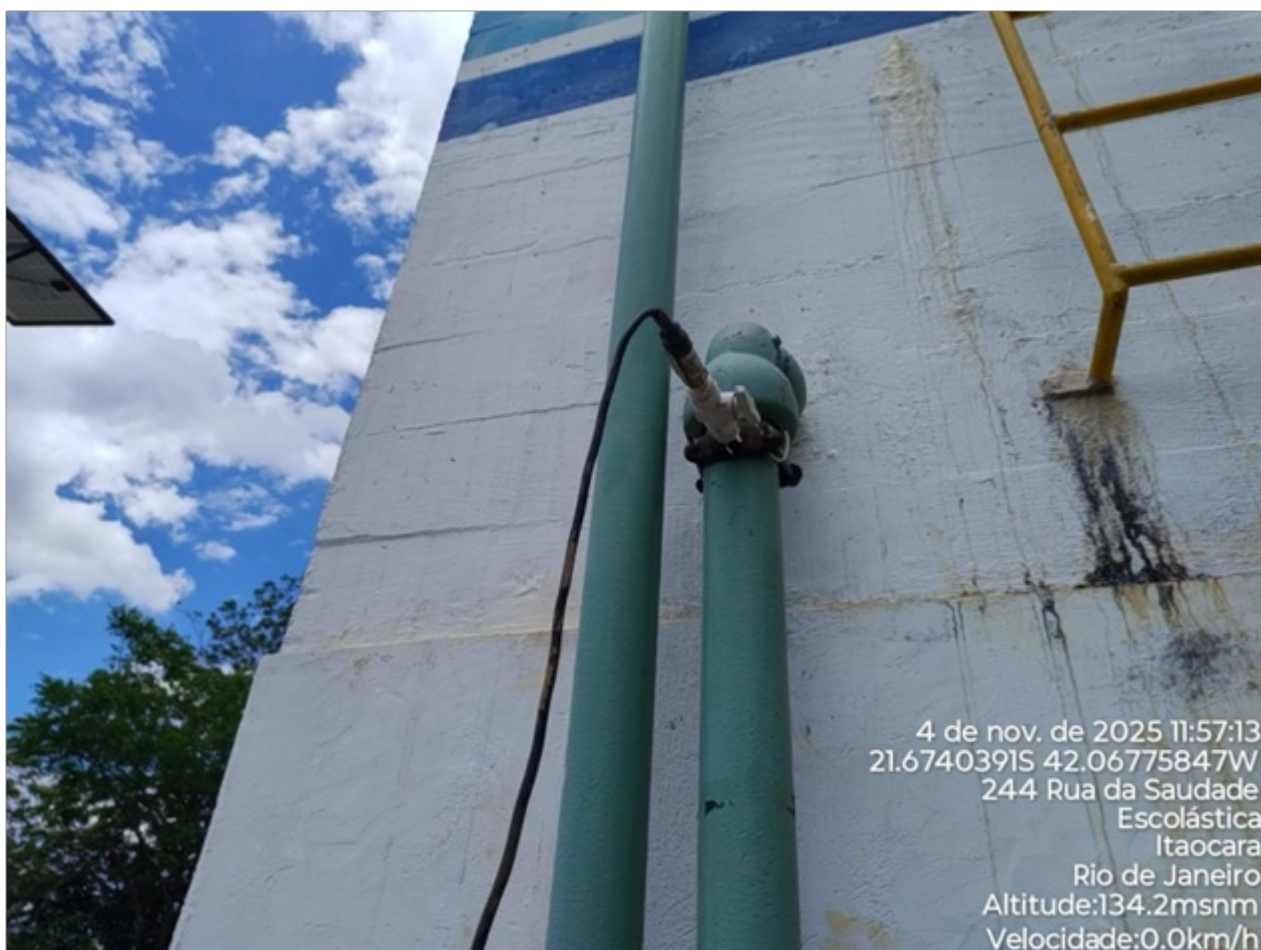
Foto 04: Sensor de telemetria na tubulação de saída do reservatório.
