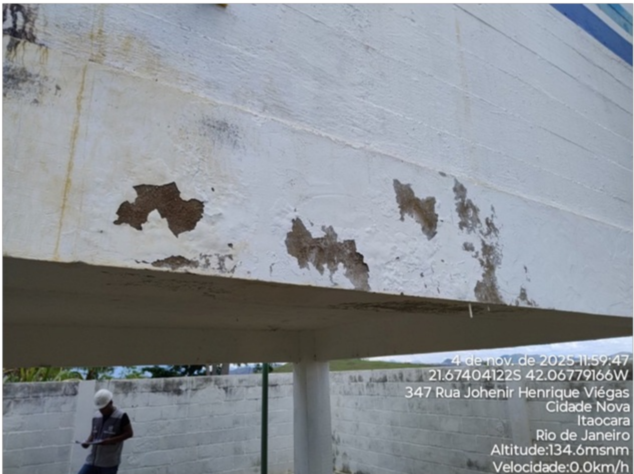
Foto 07: Pontos de infiltração na estrutura do reservatório.
