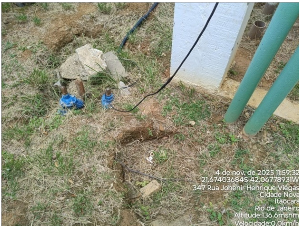
Foto 06: Válvulas do reservatório.
