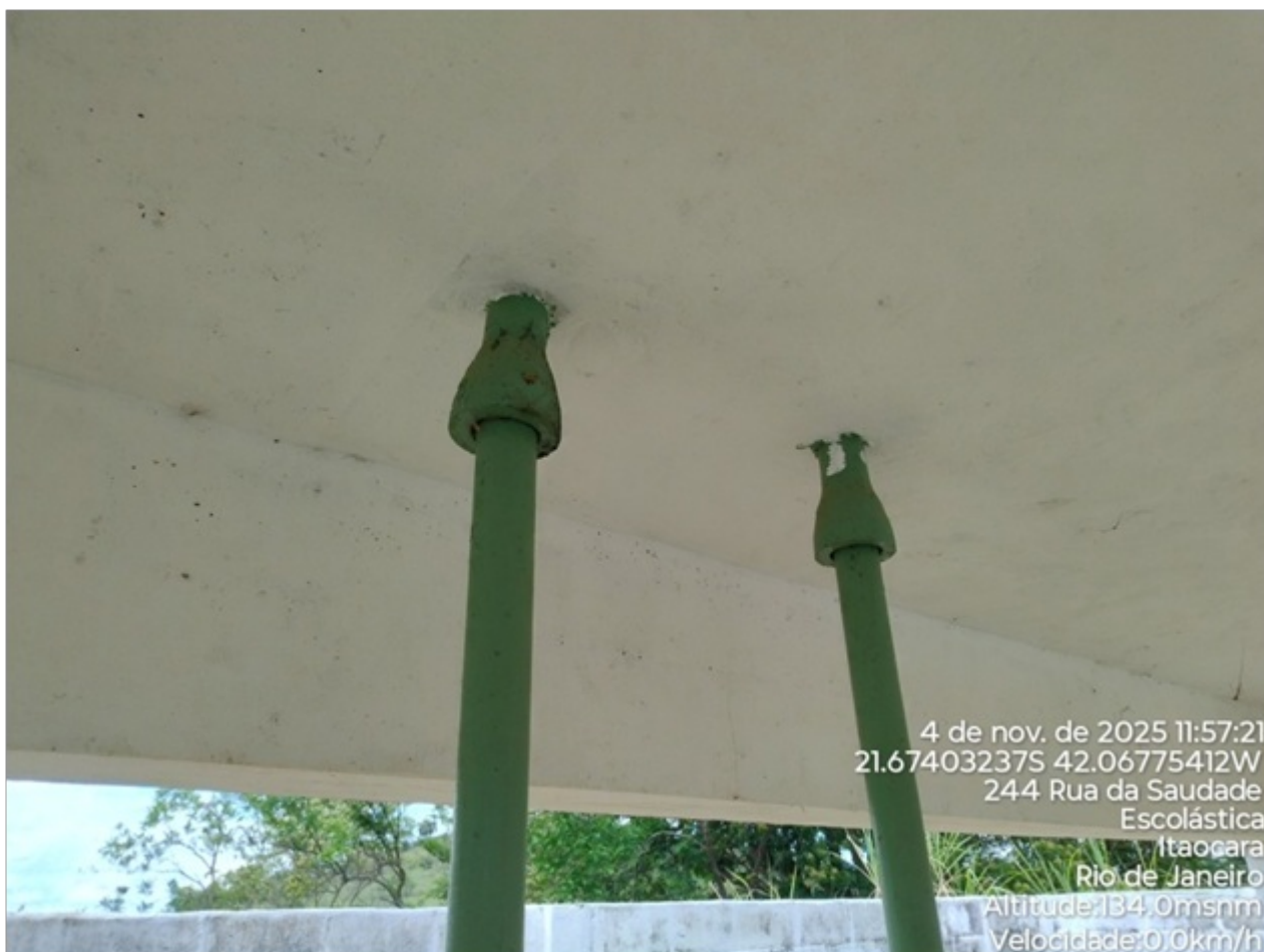
Foto 05: Tubulações de limpeza do reservatório.
