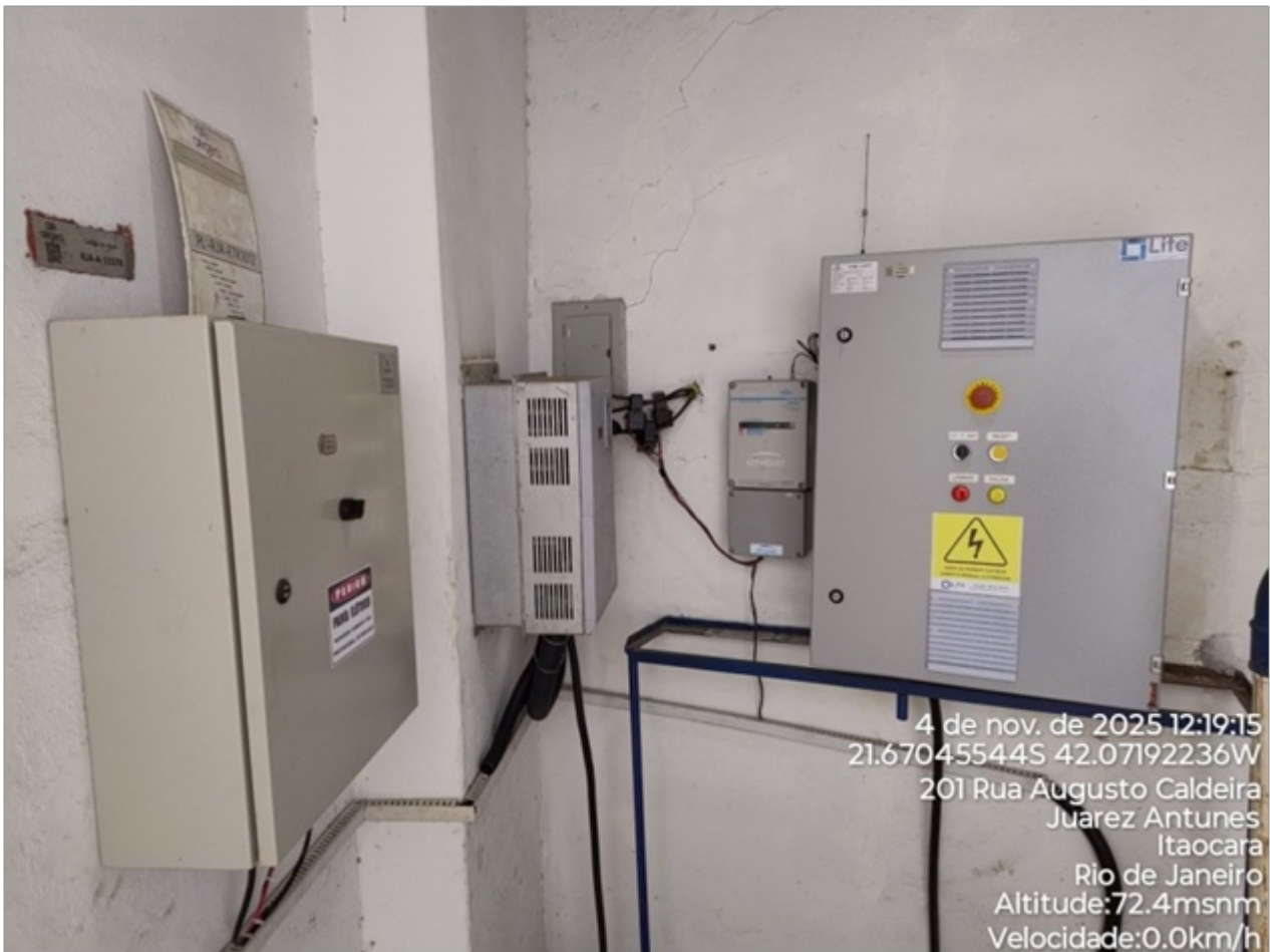
Foto 06: Pannel de comando da EEAT.
