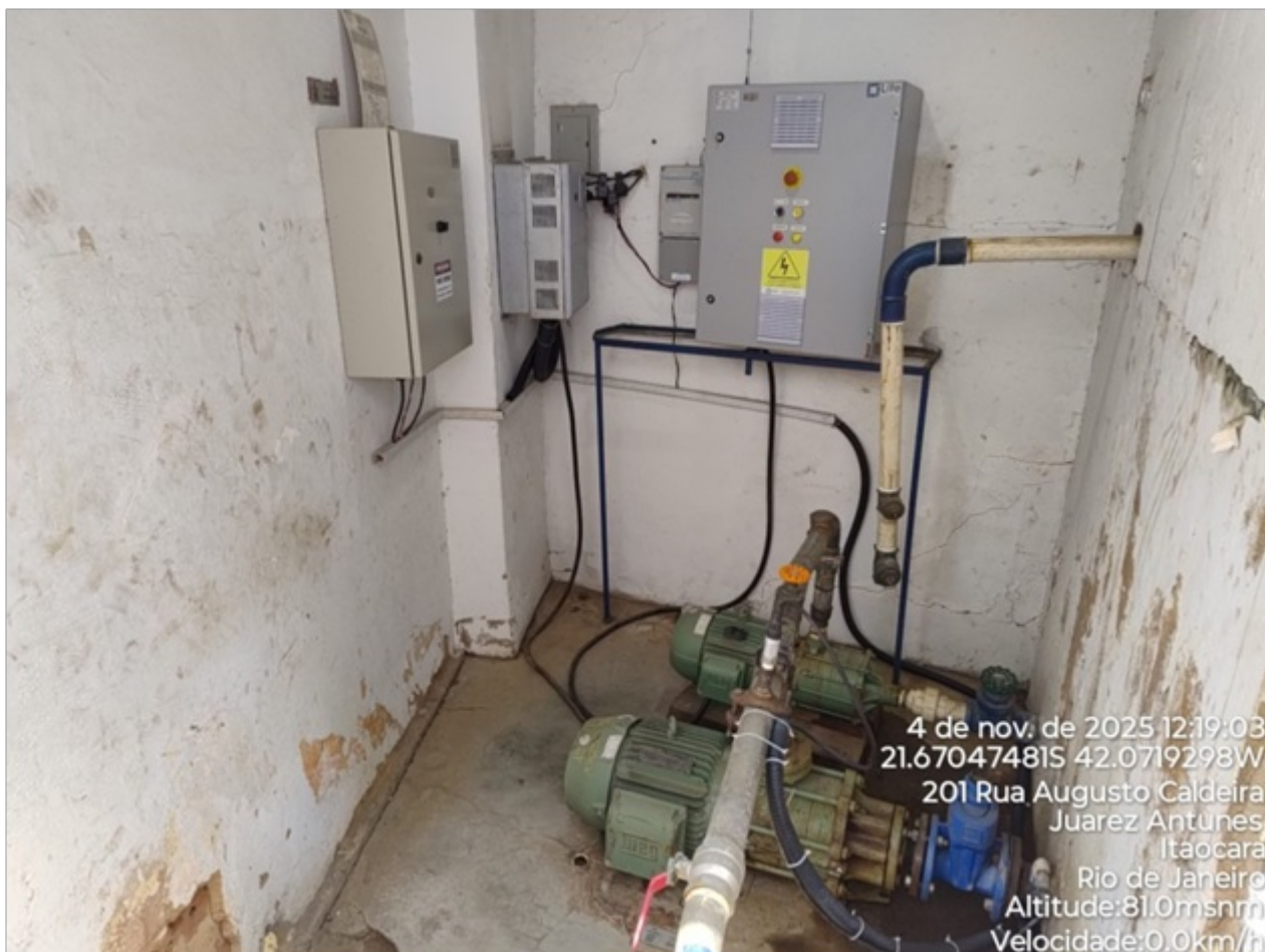
Foto 04: Bombas e painel de comando.
