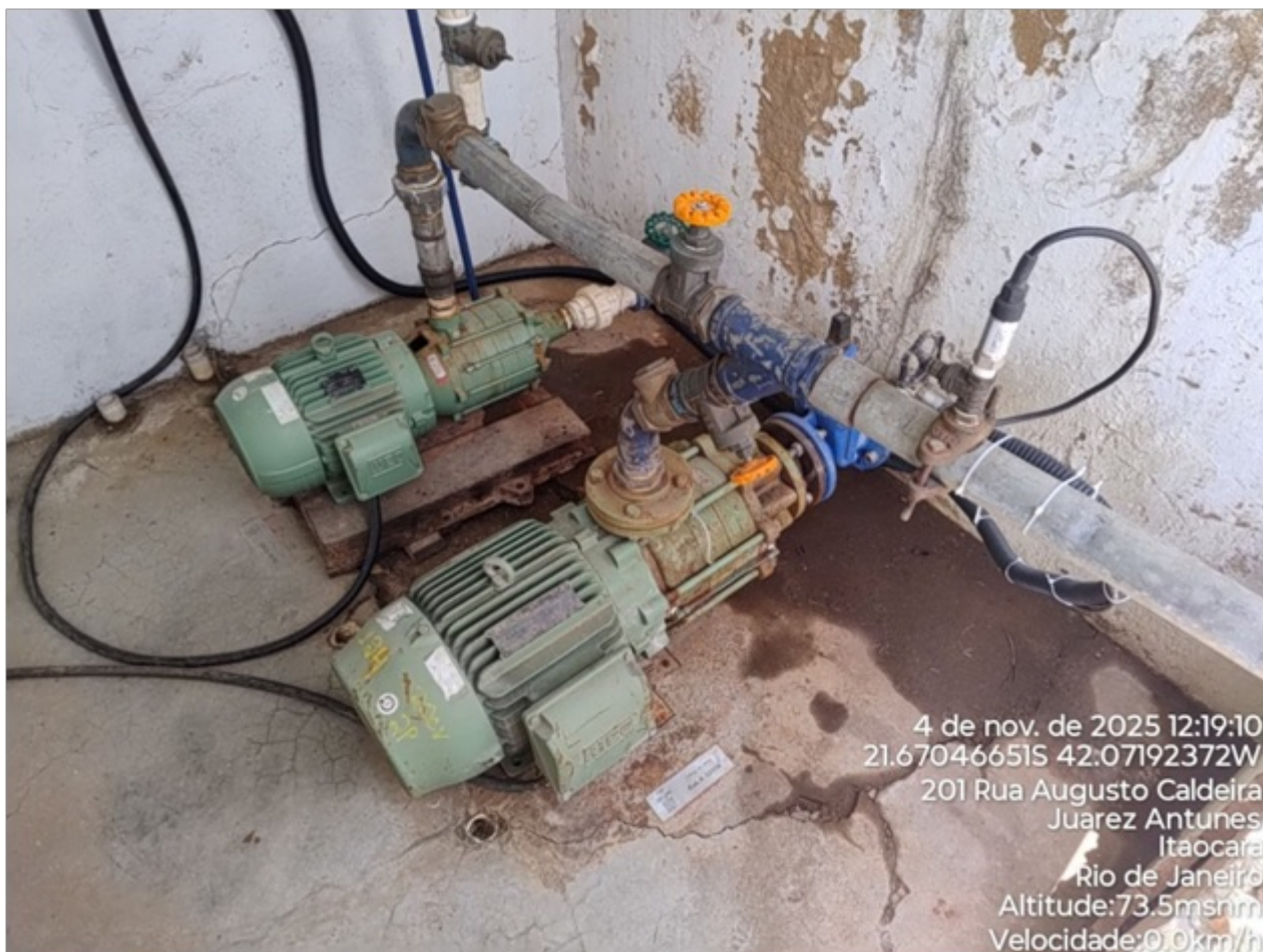
Foto 05: Bombas da EEAT e sensores de pressão.
