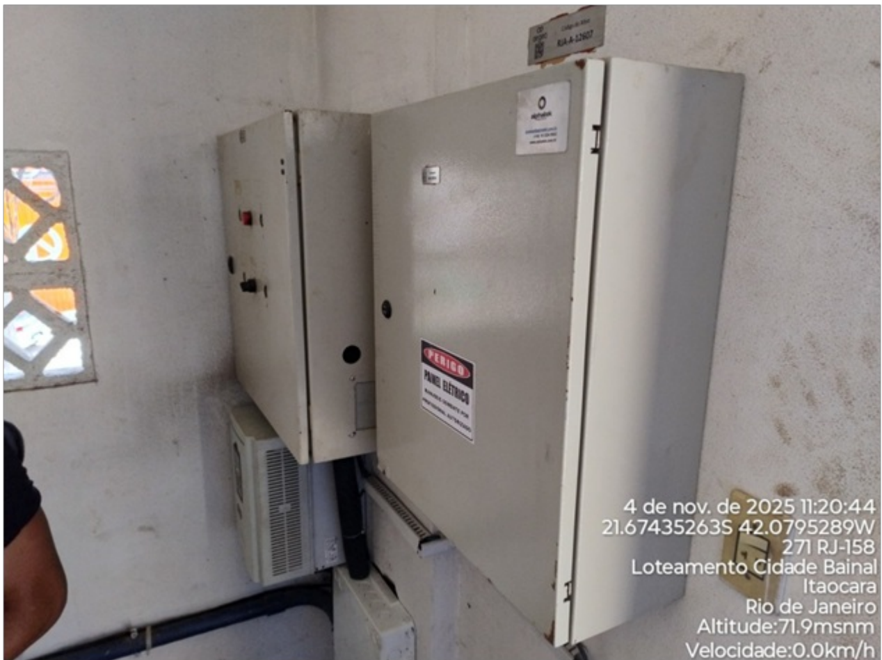
Foto 07: Paine de comando da EEAT.
