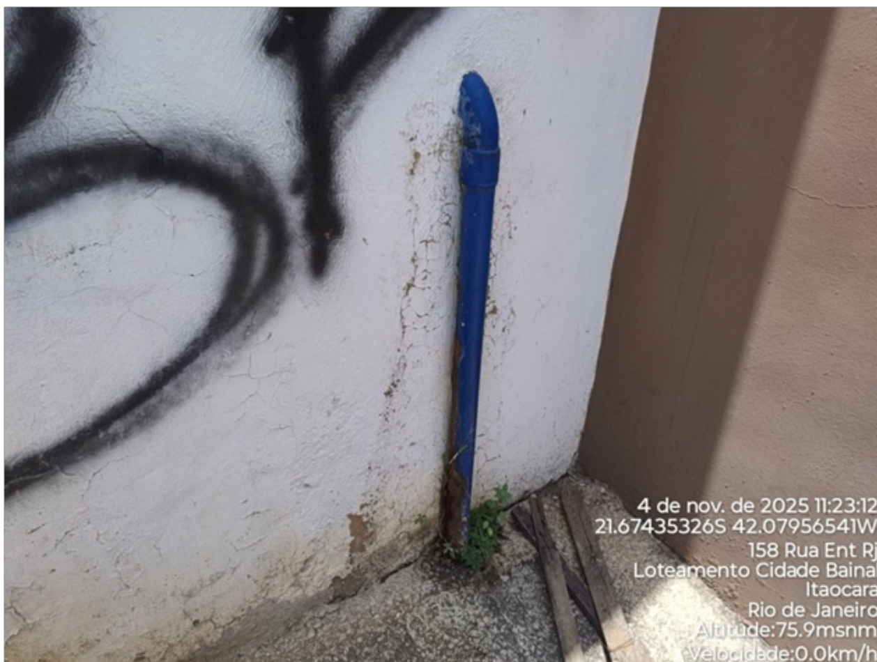
Foto 05: Tubulação de entrada da EEAT.
