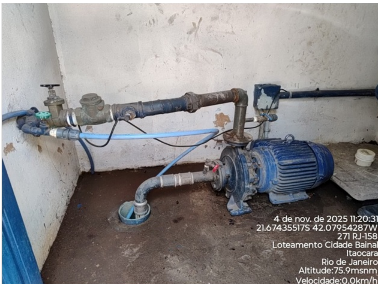
Foto 06: Bomba e tubulações da EEAT.
