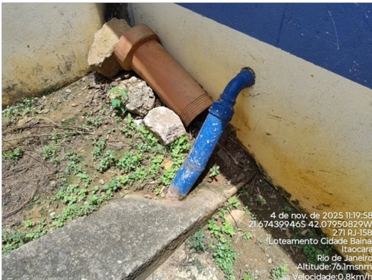
Foto 04: Tubulação de saída da EEAT.
