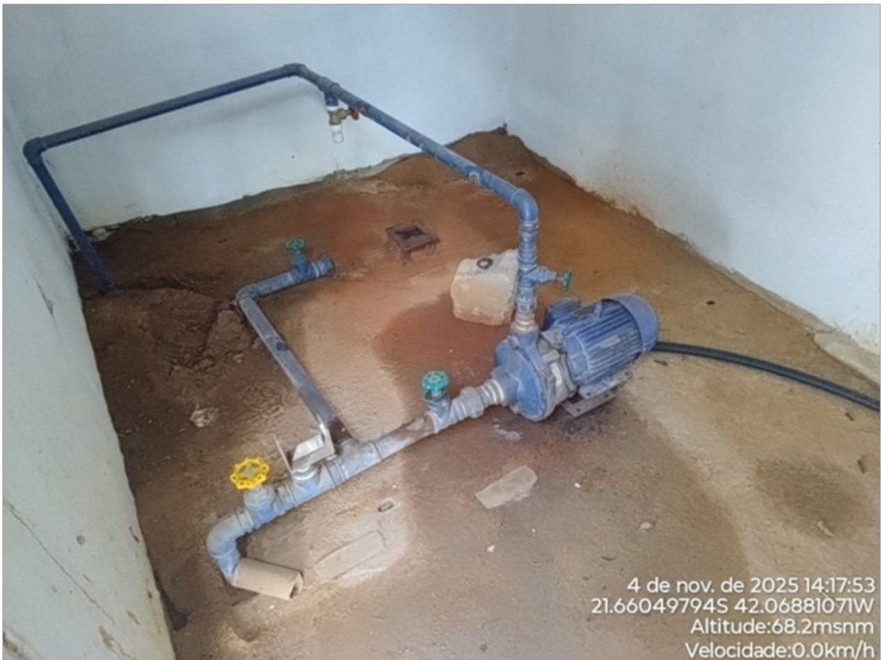
Foto 06: Bomba e tubulações da EEAT.
