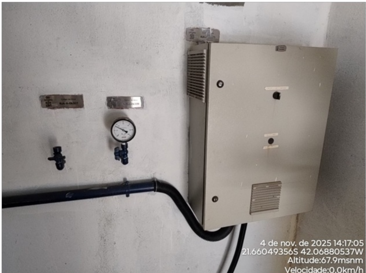
Foto 05: Pannel de comando da EEAT.
