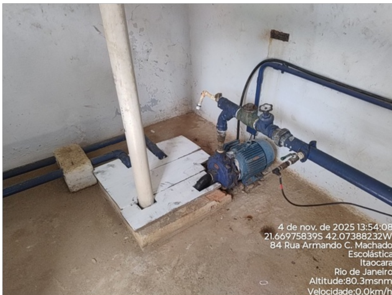
Foto 04: Bomba da EEAT.
