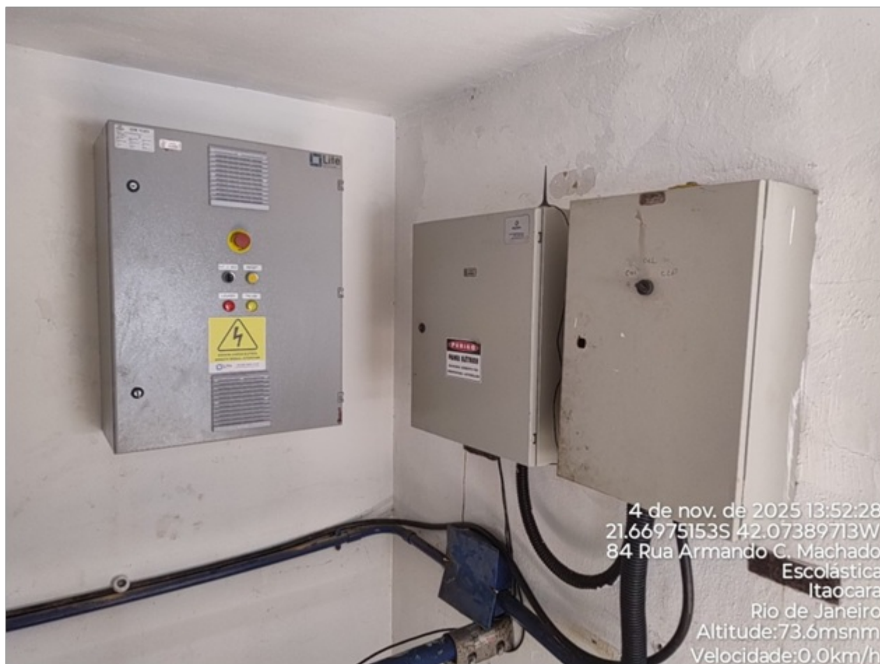
Foto 05: Paineis de comando da EEAT.
