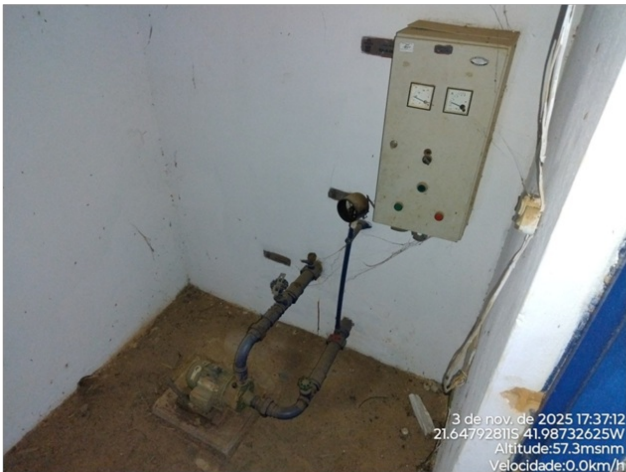
Foto 03: Bomba e painel de comando da EEAT.
