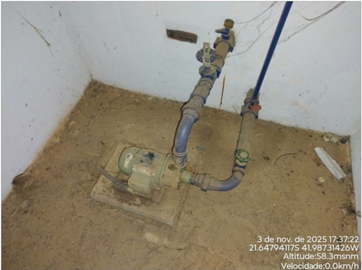
Foto 04: Bomba da EEAT.
