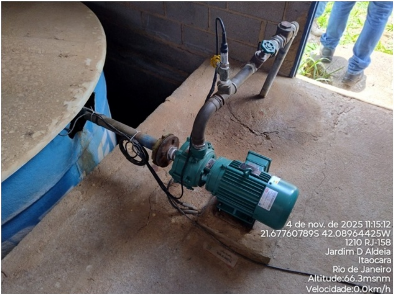
Foto 07: Bomba da EEAT com medidores da telemetria.
