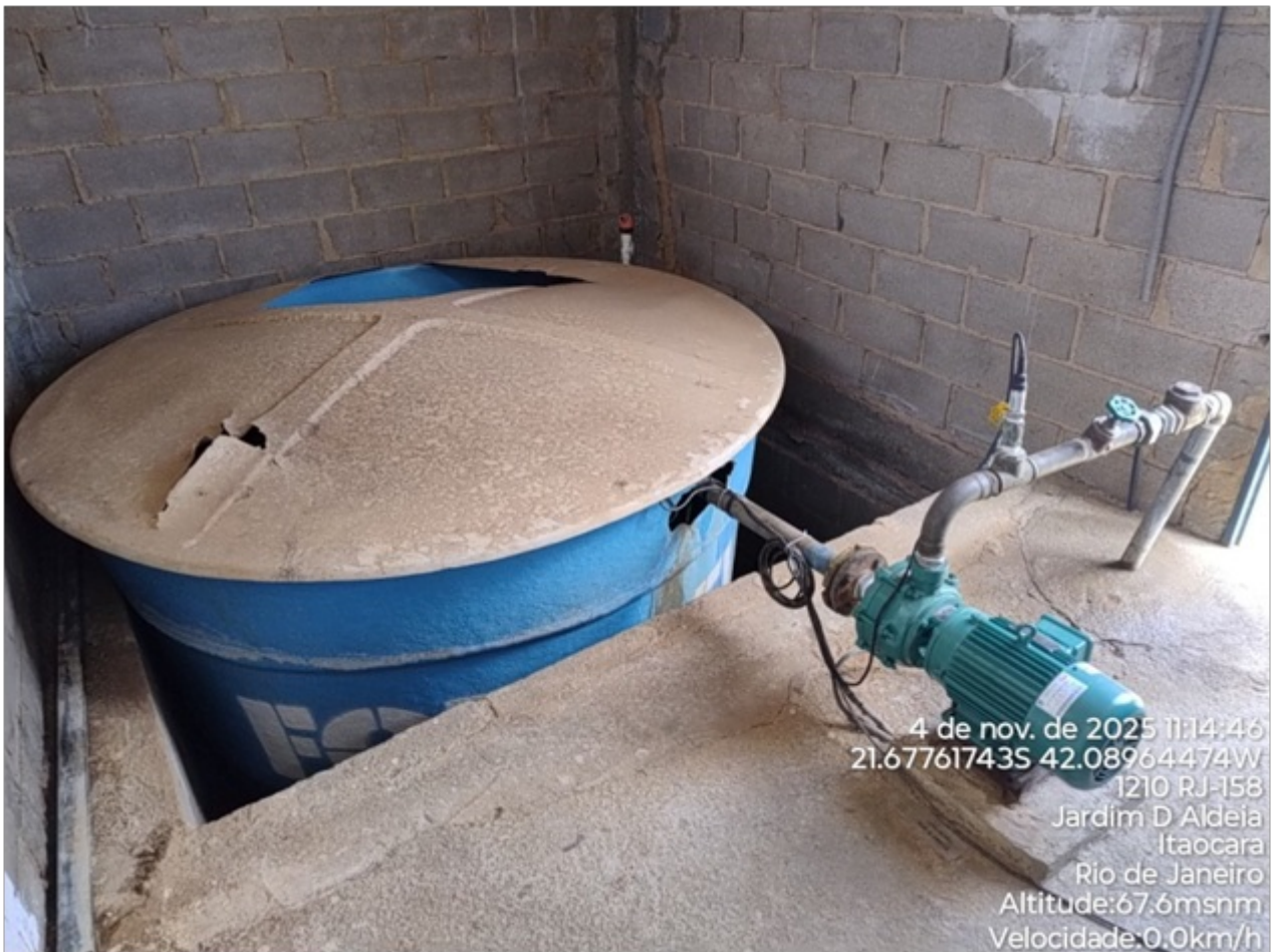
Foto 06: Cobertura do reservatório danificada.
