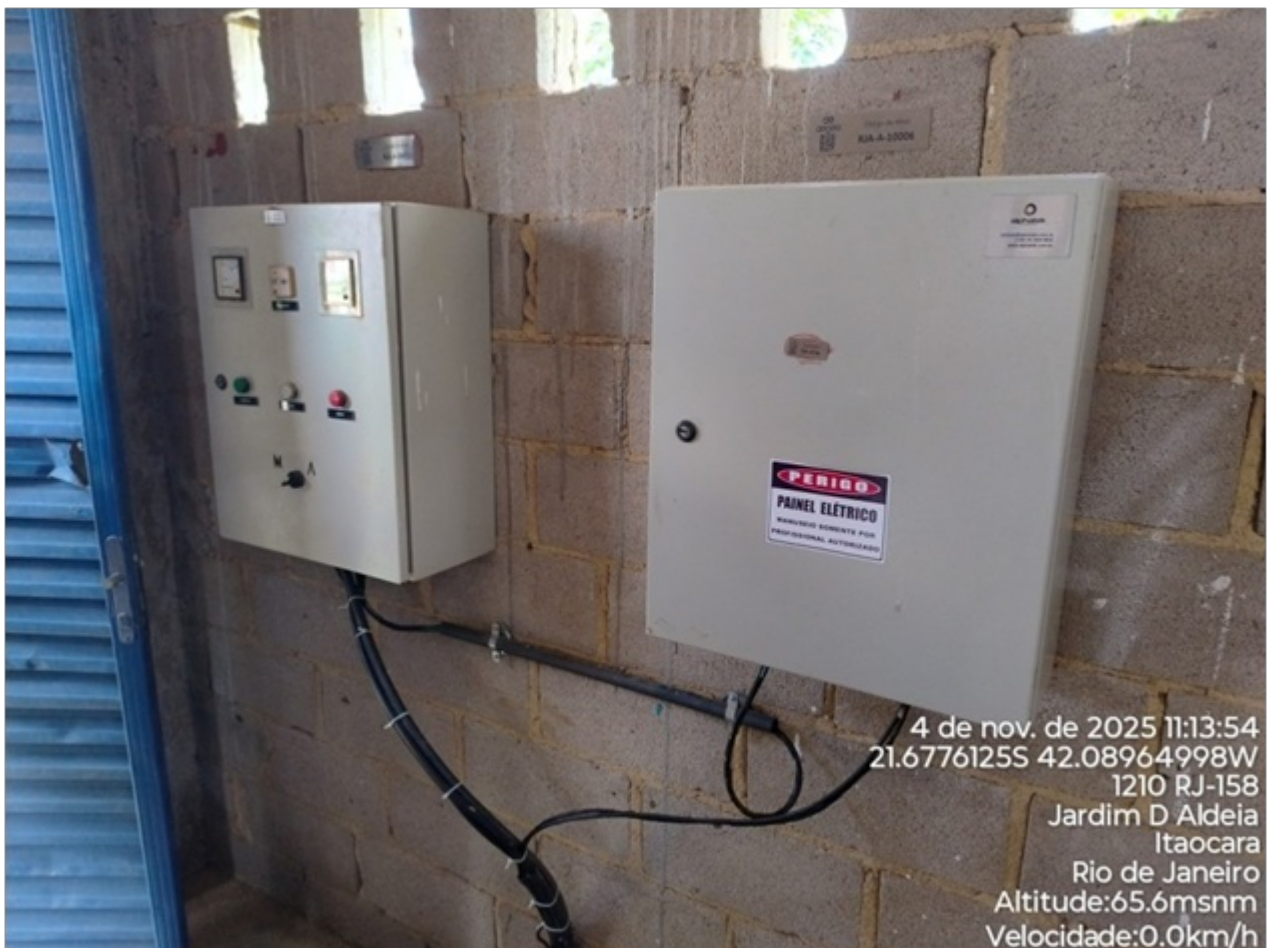
Foto 05: PAINEL de comando da EEAT.
