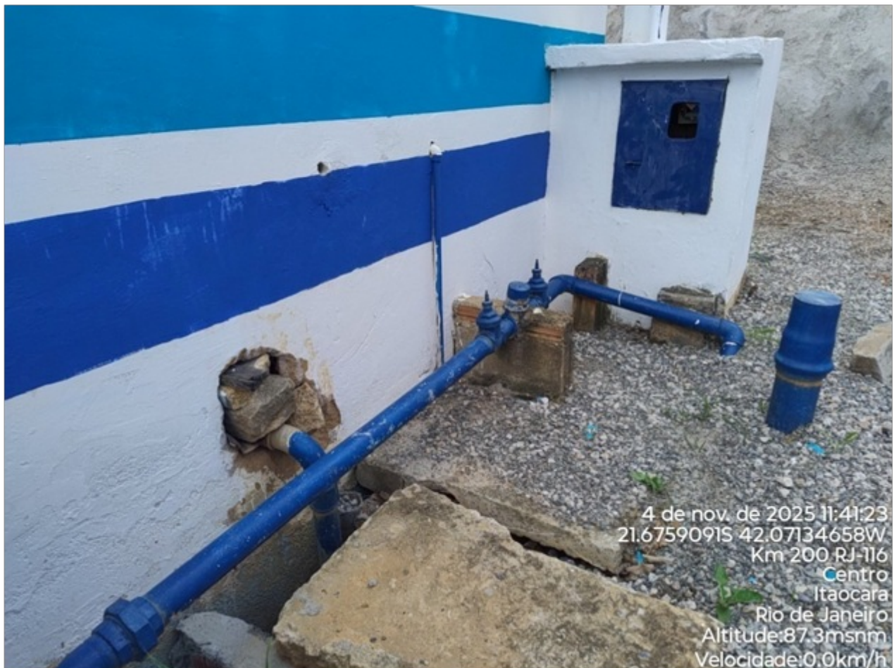
Foto 05: Tubulações de entrada e saída da elevatória.
