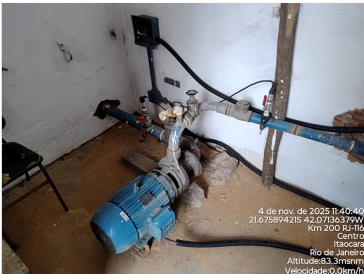
Foto 03: Bomba da elevatória com sensores de pressão.
