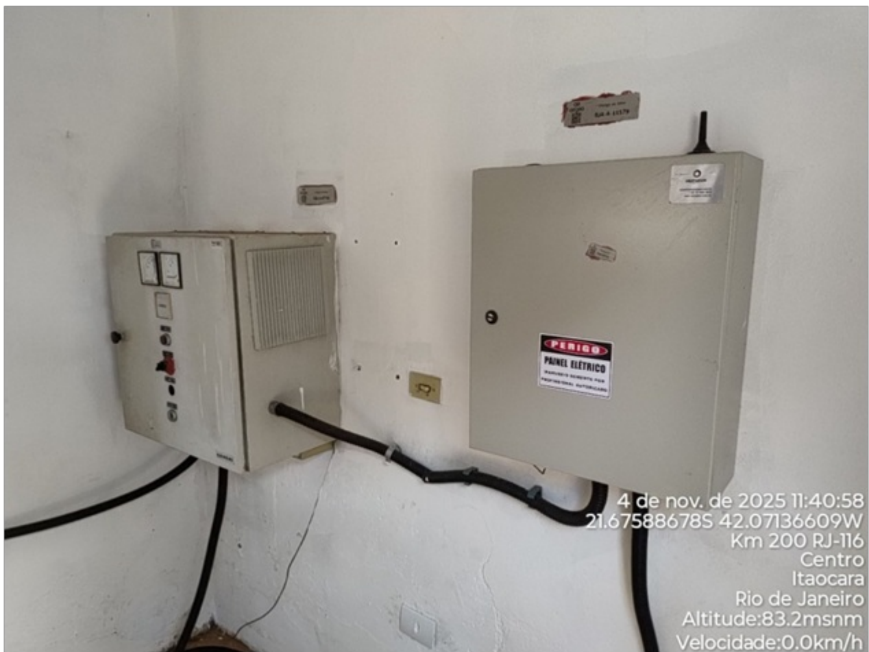
Foto 04: Paineis de comando da elevatória.
