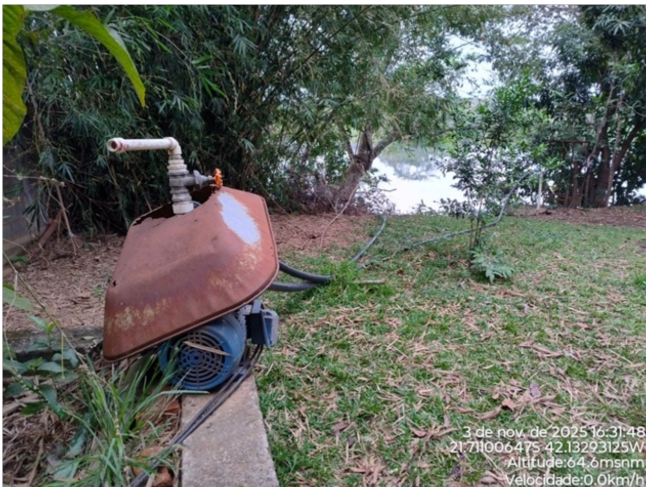
Foto 01: Ausência de abrigo para a bomba da captação.
