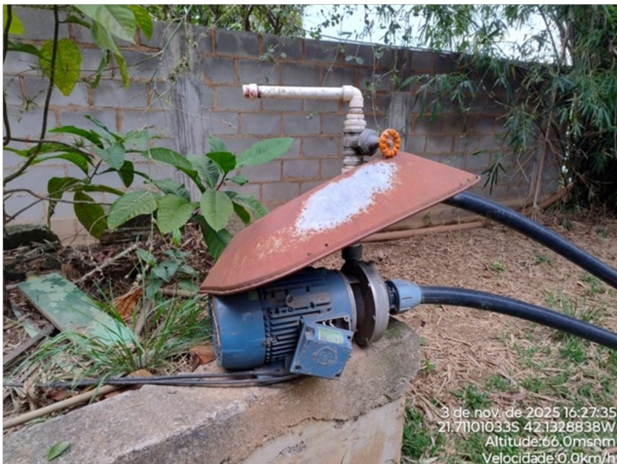
Foto 02: Ausência de abrigo para a bomba da captação.
