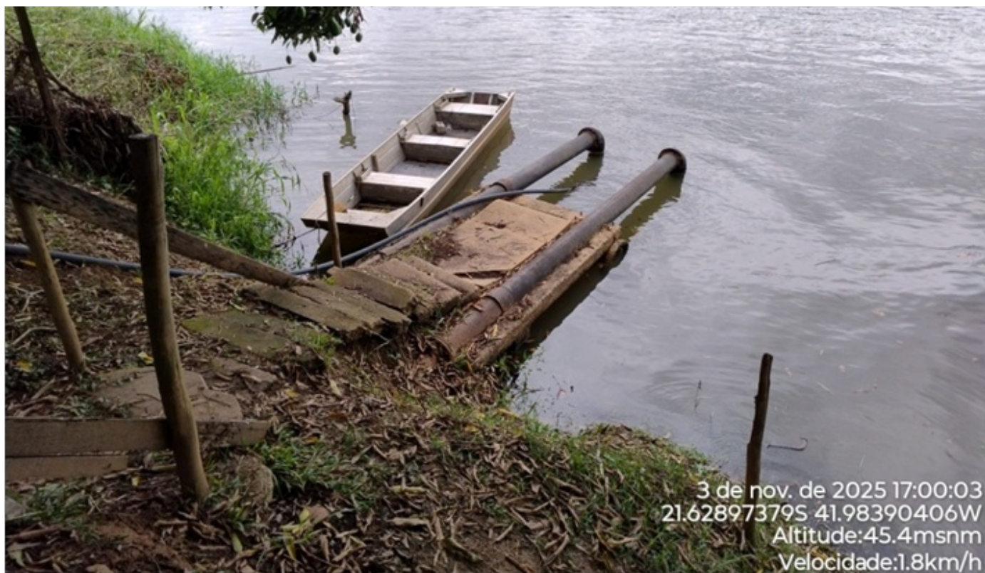
Foto 03: Tomada de captação.
