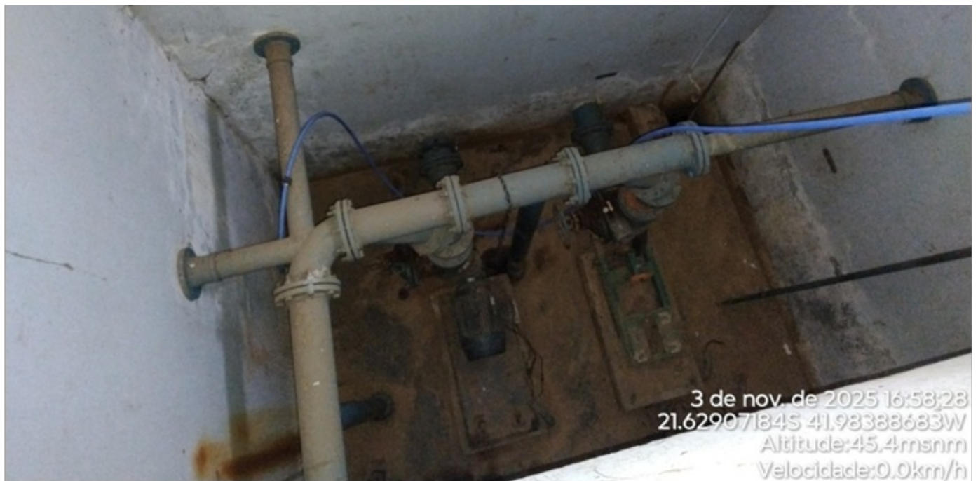
Foto 05: Bombas da EEAB.
