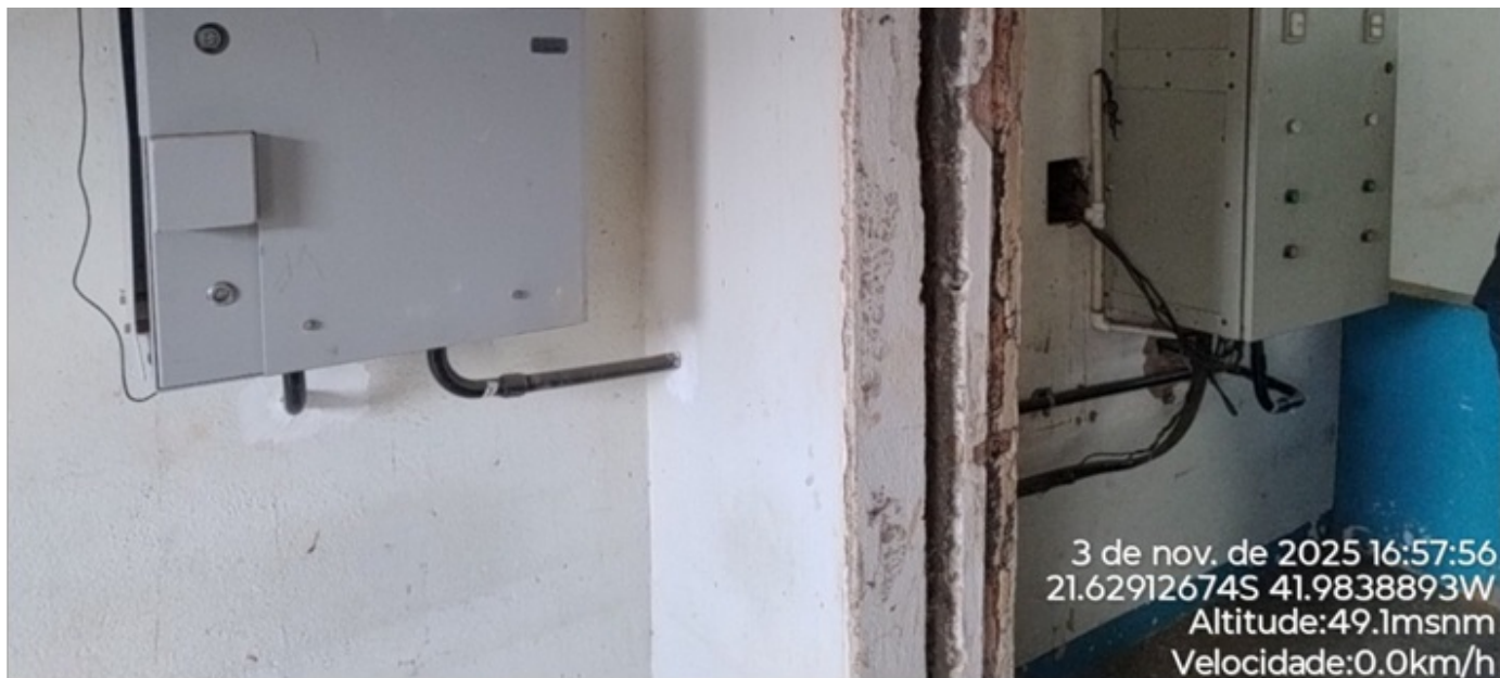
Foto 06: Paineis de comando e telemetria da EEAB.
