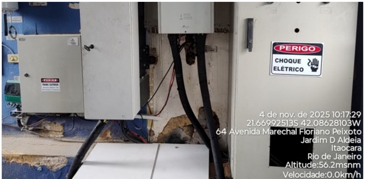
Foto 06: Pannel de comando da EEAB.
