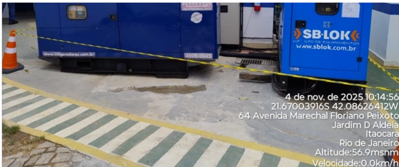
Foto 08: Gerador de energia elétrica em caso de interrupção no fornecimento da distribuidora.
