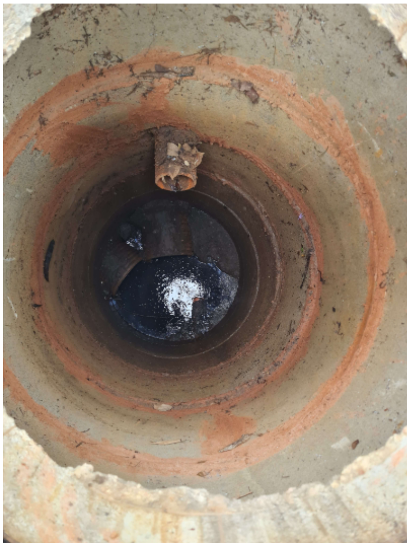
Figura 6. Exemplo de PV que aparenta necessitar de tubo de queda.
