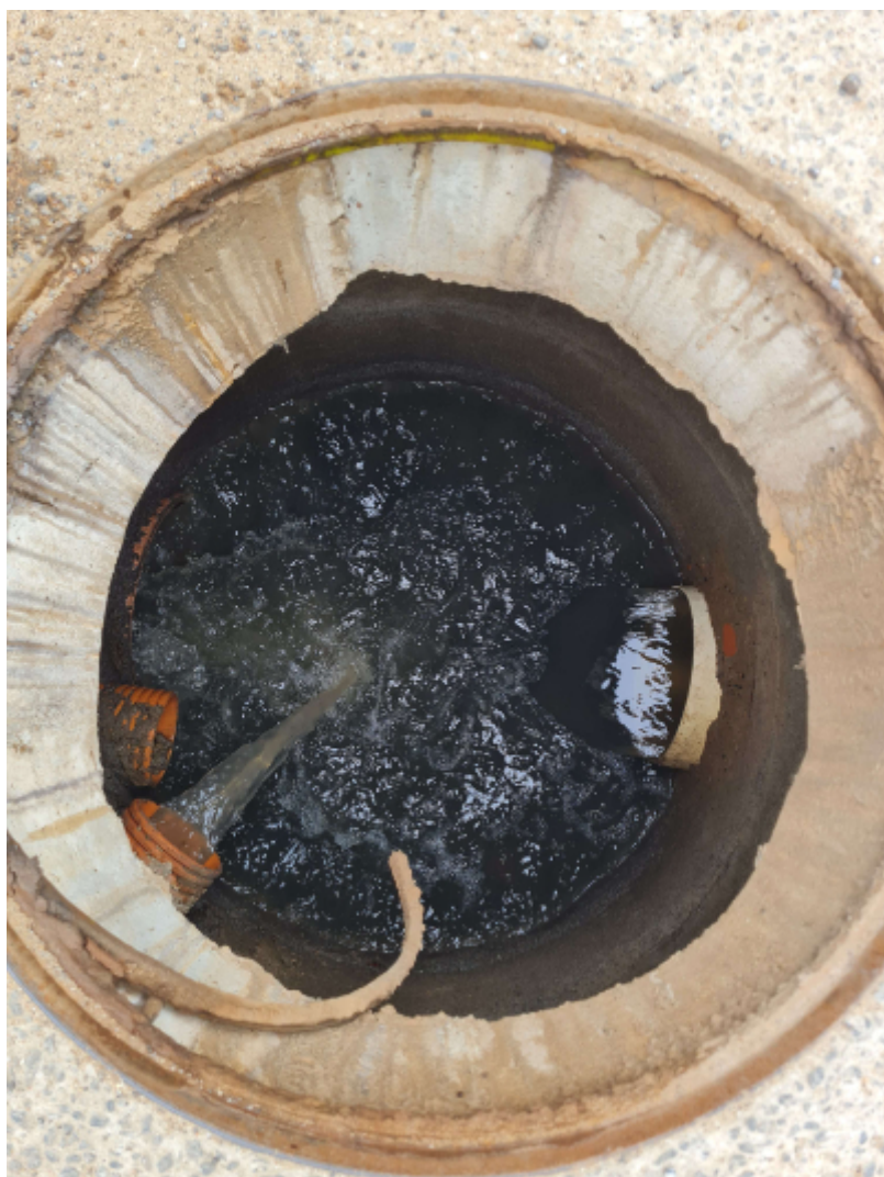
Figura 5. Exemplo de CTS inadequado às normas técnicas.
