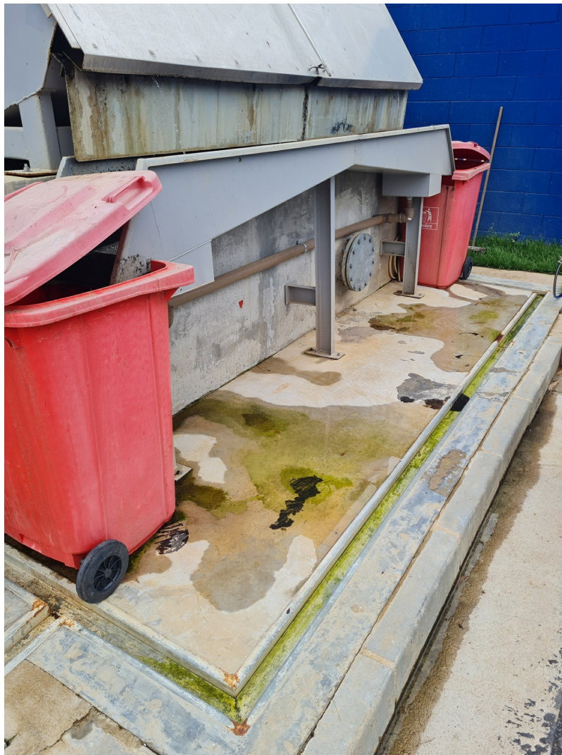
Figura 1: Esgoto vazando do processo de peneiramento
